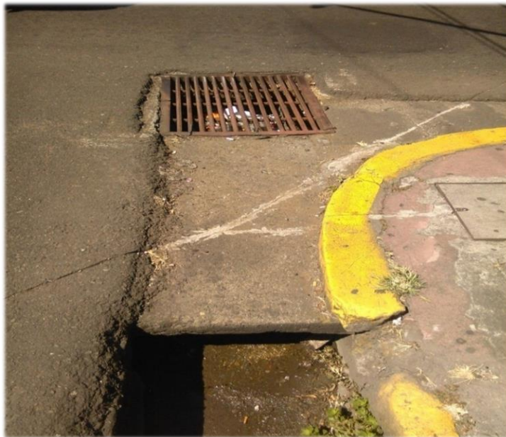
Figura 11. Rampa de acceso que interfiere con el flujo de agua.
