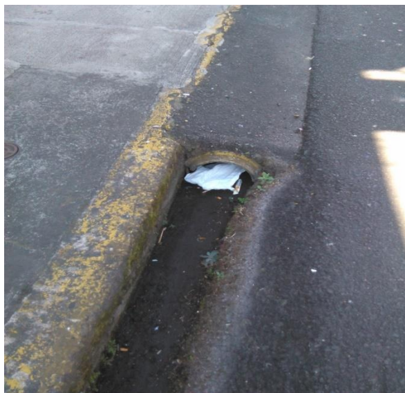
Figura 14. Rampa para vehículos que obstruye el paso de caudal.
