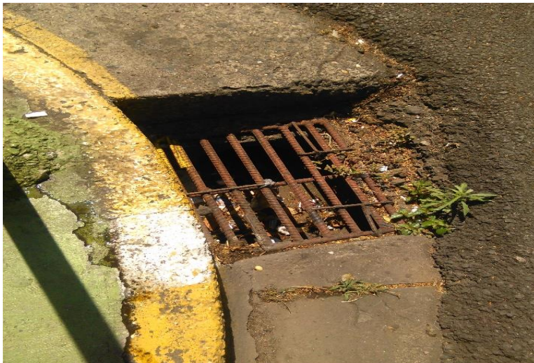
Figura 9. Alcantarilla con Basura.
