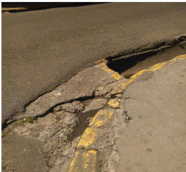
Figura 8. Cordón de Caño dañado.
