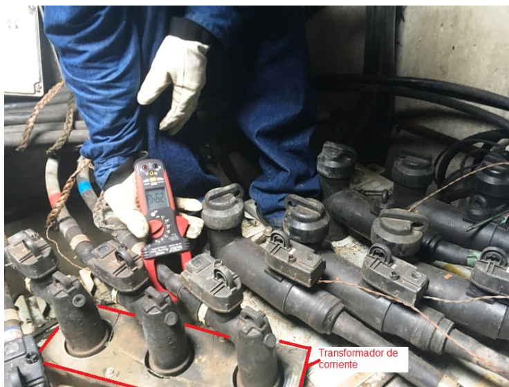
Figura 3.8. Transformadores de corriente en interruptor Fuente propia.
