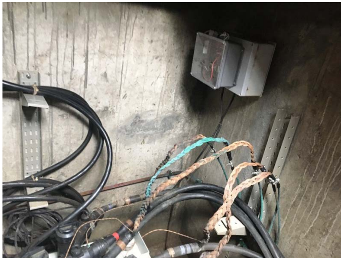
Figura 3.7. Montaje del sistema de monitoreo en cámara de interruptor M02 17-0307 Fuente propia.
