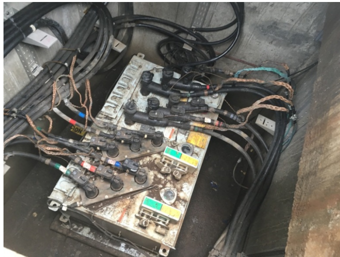
Figura 3.10. Interruptor M02 17-0307, sitio donde se instaló el sistema de monitoreo Fuente propia
