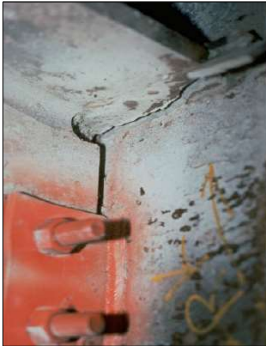
Figura 1. Fractura de soldadura de penetración completa en una conexión de pórtico resistente a momento. Fuente: Crisafulli, 2018.
