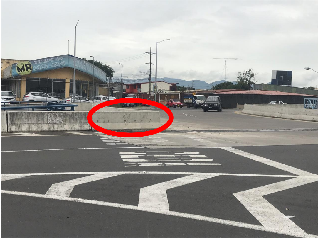
Ilustración 17. Muro ubicado en entrada 5 que dificulta la visibilidad.
