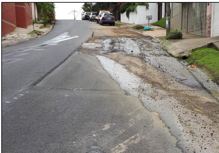
Figura J - 2 Tramo sin sobrecapa por presencia de fuga
