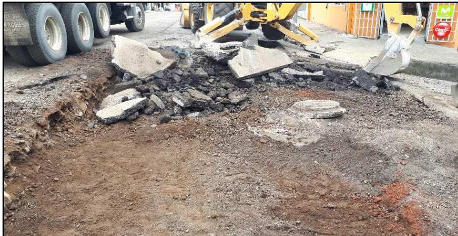
Figura J - 1 Carpeta asfáltica existente sin base granular y/o mejorada
