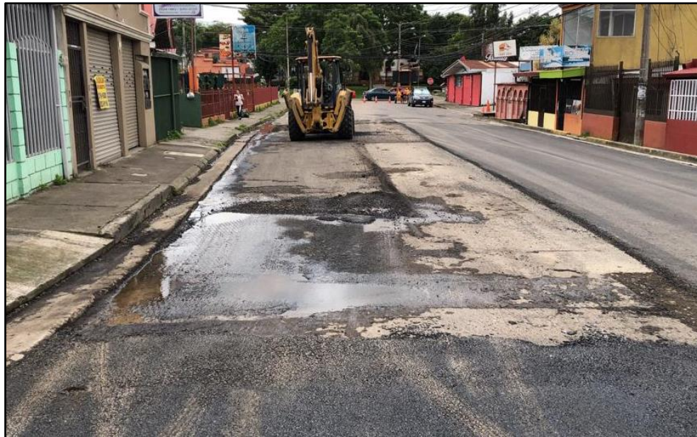
Figura K - 1 Alcantarilla de ladrillo colapsada
