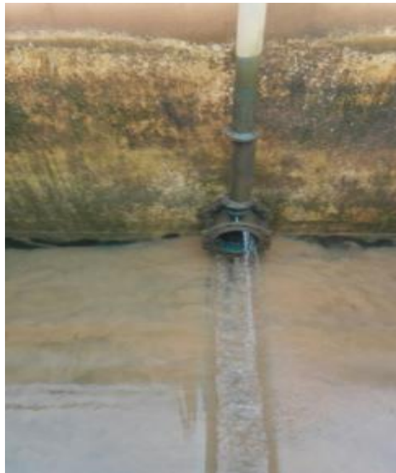
Ilustración 30 Lavado de filtro
