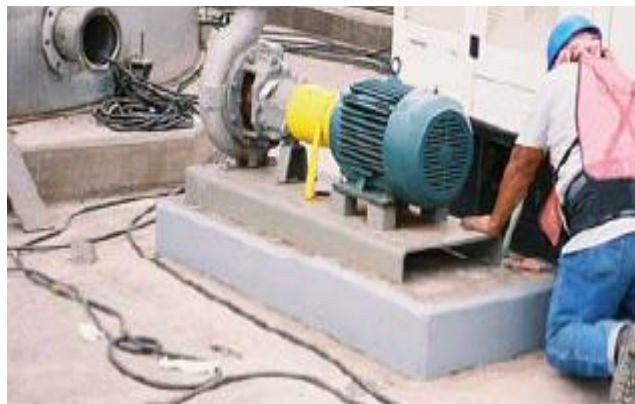
Figura 47. Soportes de maquinaria de concreto polimérico
