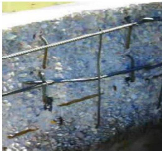
Figura 42. Estructura atacada por sulfatos, retiro del concreto
