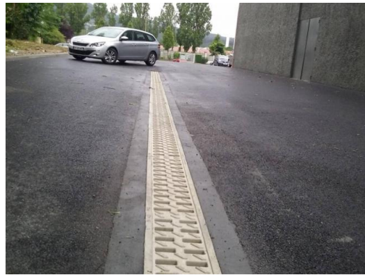
Figura 39. Canales de drenaje en la región de Ródano-Alpes en Francia
