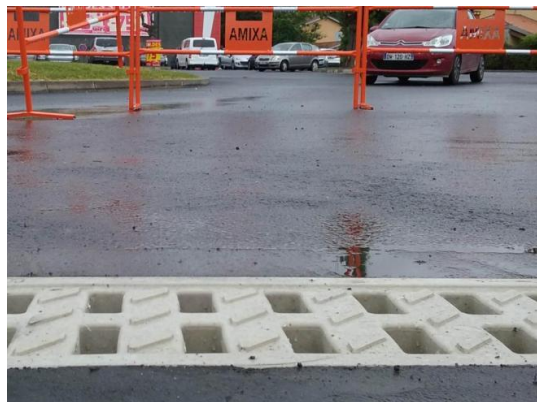
Figura 40. Canales de drenaje en la región de Ródano-Alpes en Francia
