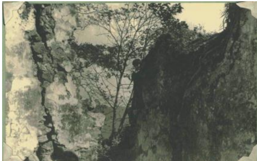
Figura 5.24. Fotografía de desplome de la grieta de la pared
