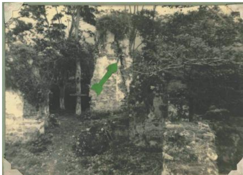
Figura 5.23. Fotografía de la grieta de la pared
