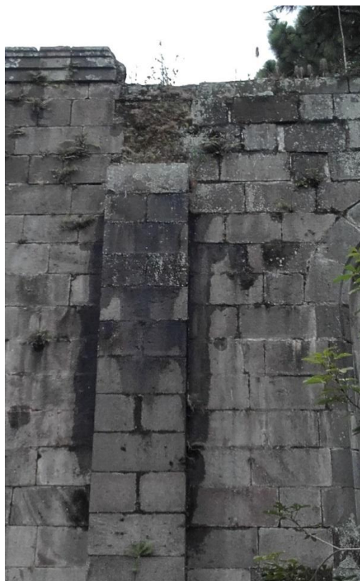
Figura 4.24. Fotografía del contrafuerte con desprendimiento superior Fuente: MCRUZ, 2002, p. 4
