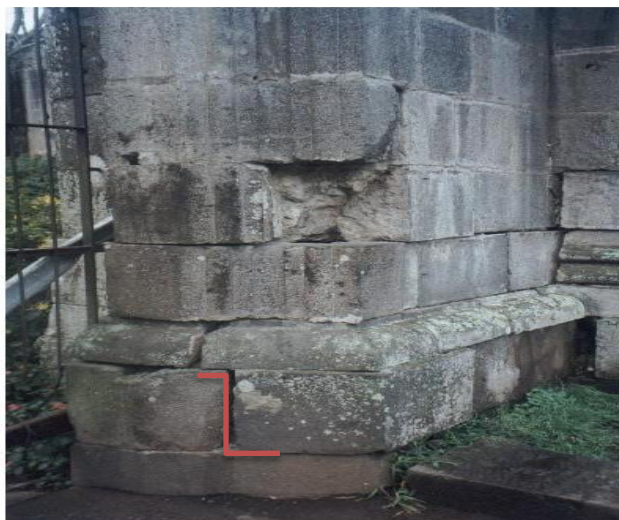
Figura 4.25. Desplome de 8 cm en el contrafuerte del templo Santiago Apóstol
