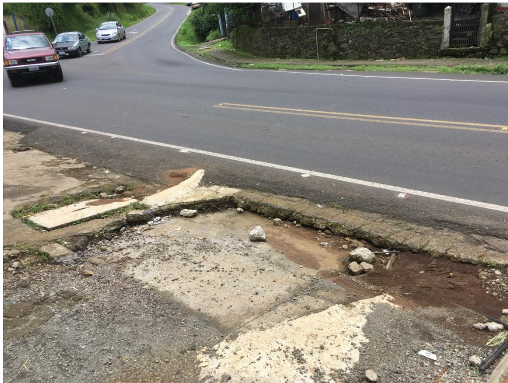
Figura 25. Deficiencias de intersección Fuente: Propiedad del autor (2017)
