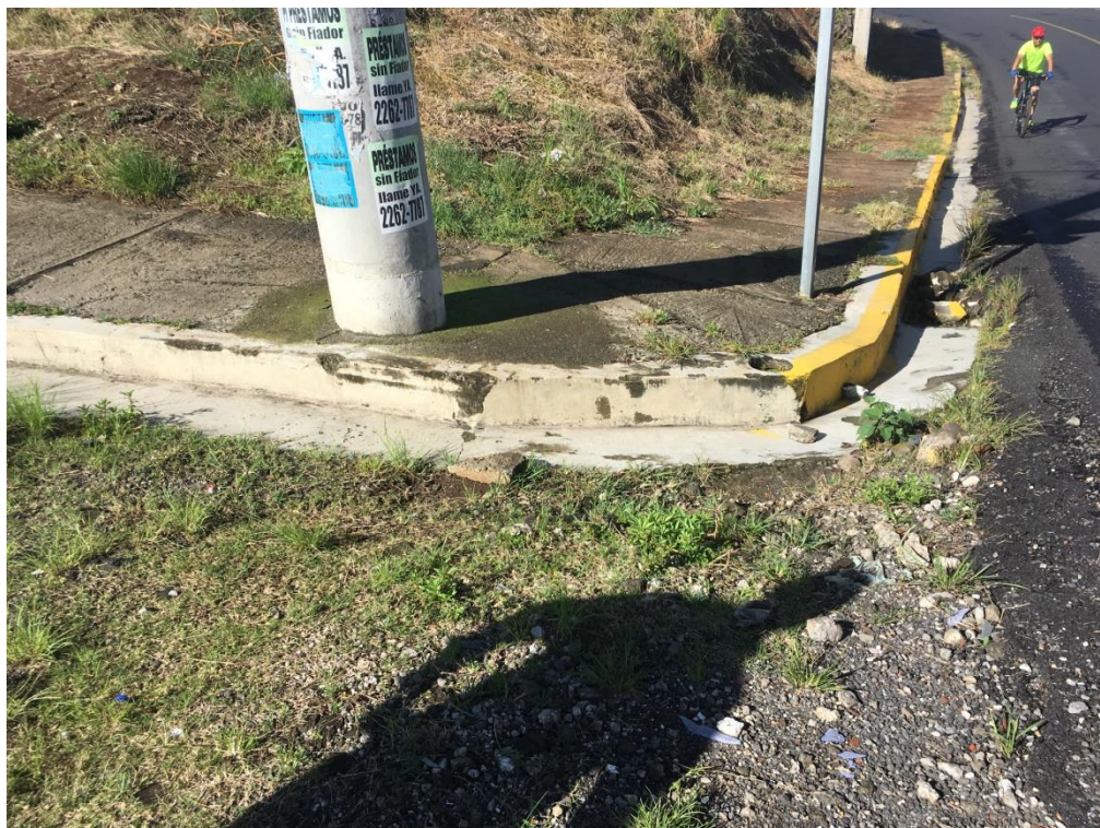
Figura 42. Deficiencias de intersección Fuente: Propiedad del autor (2017)
