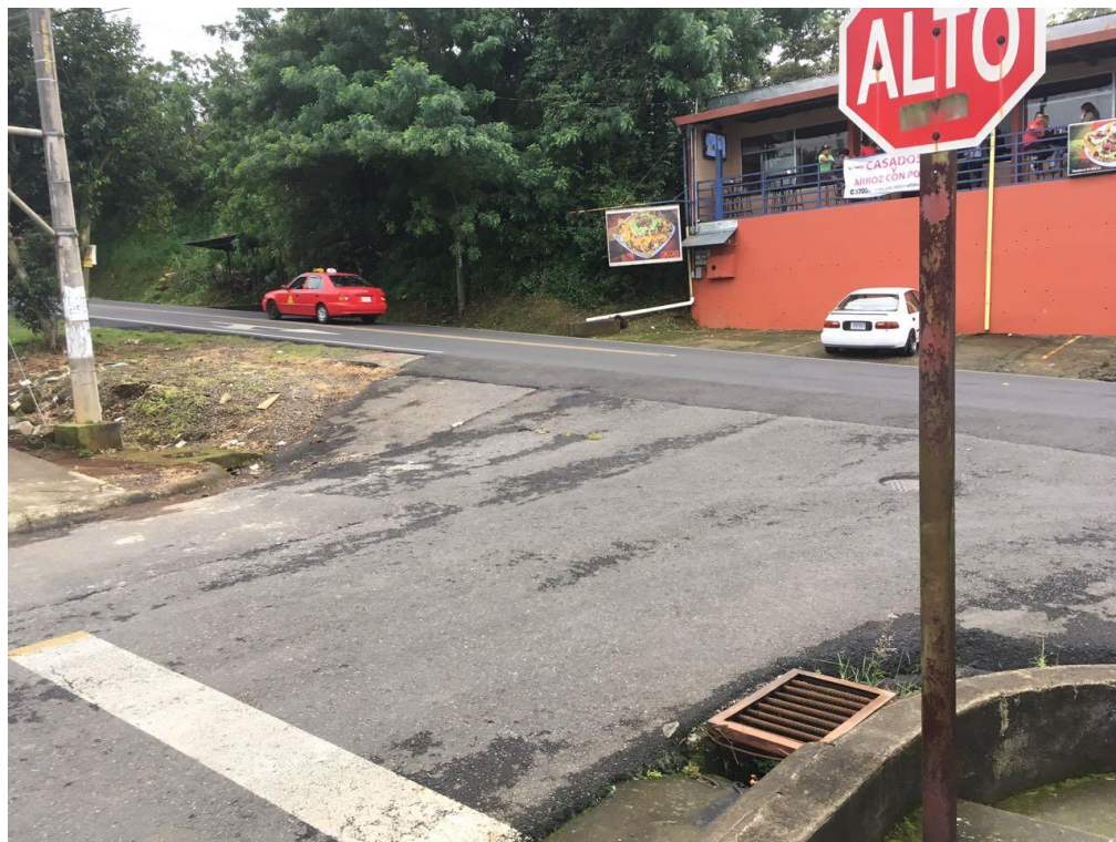
Figura 44. Deficiencias de intersección Fuente: Propiedad del autor (2017)
