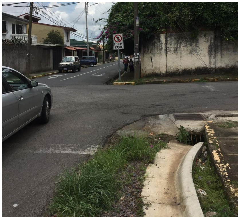
Figura 14. Deficiencias de intersección Fuente: Propiedad del autor (2017)
