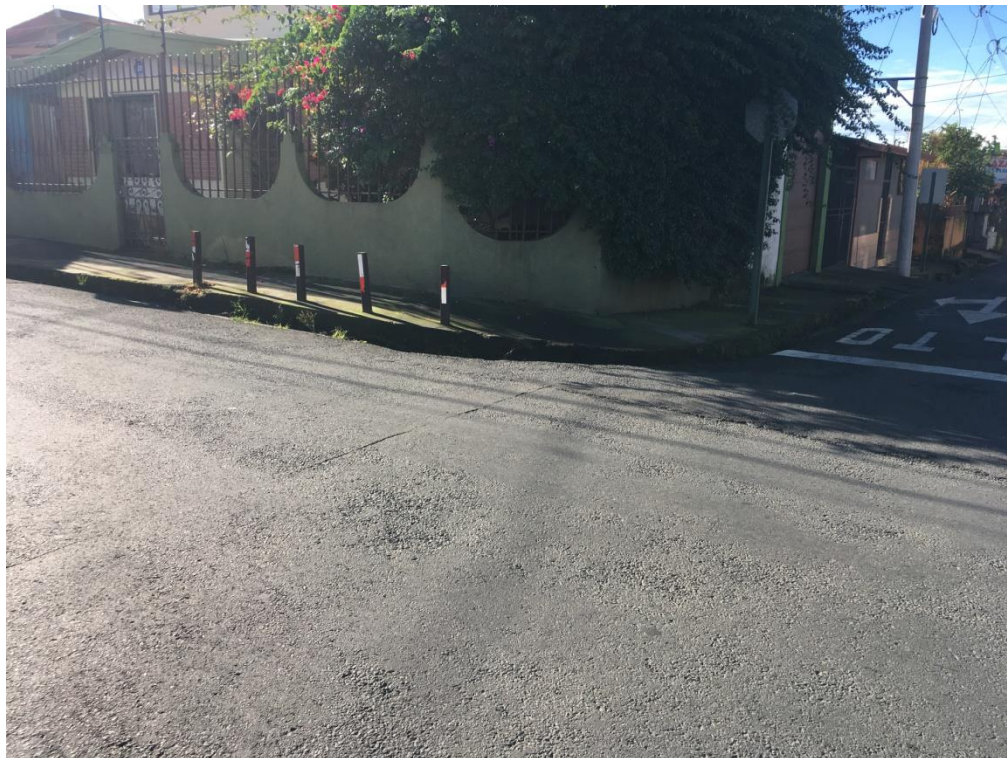
Figura 39. Deficiencias Intersección Fuente: Propiedad del autor (2017)
