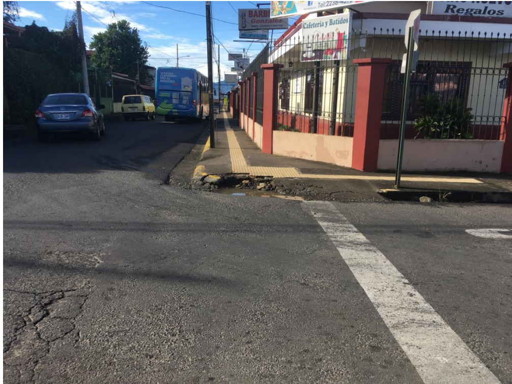
Figura 31. Deficiencias Intersección Fuente: Propiedad del autor (2017)
