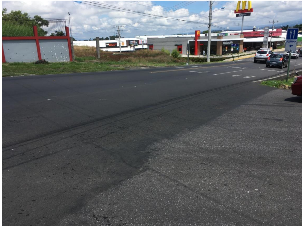
Figura 16. Deficiencias de intersección Fuente: Propiedad del autor (2017)
