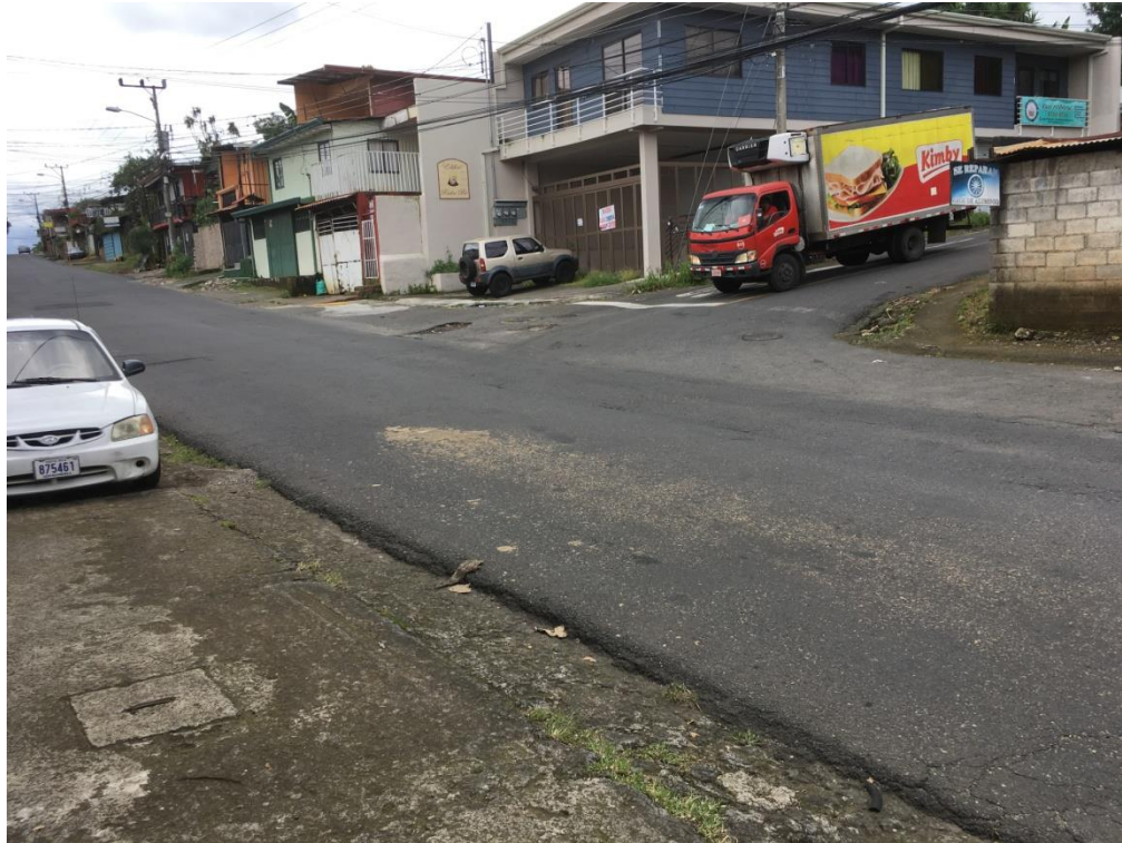
Figura 48. Deficiencias de intersección Fuente: Propiedad del autor (2017)
