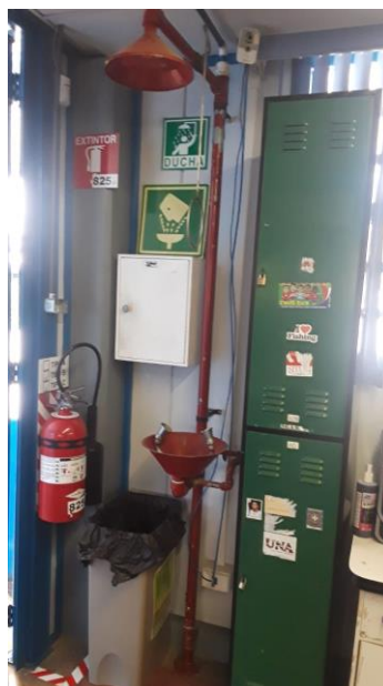
Figura 15. Detalle de la entrada con el equipo de seguridad necesario, lava ojos y ducha.
