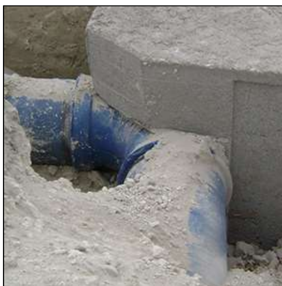
Ilustración 24 Bloque de anclaje para un cambio de dirección en 90 grados. Fuente: TRAXO, Componentes para sistemas de riego.
