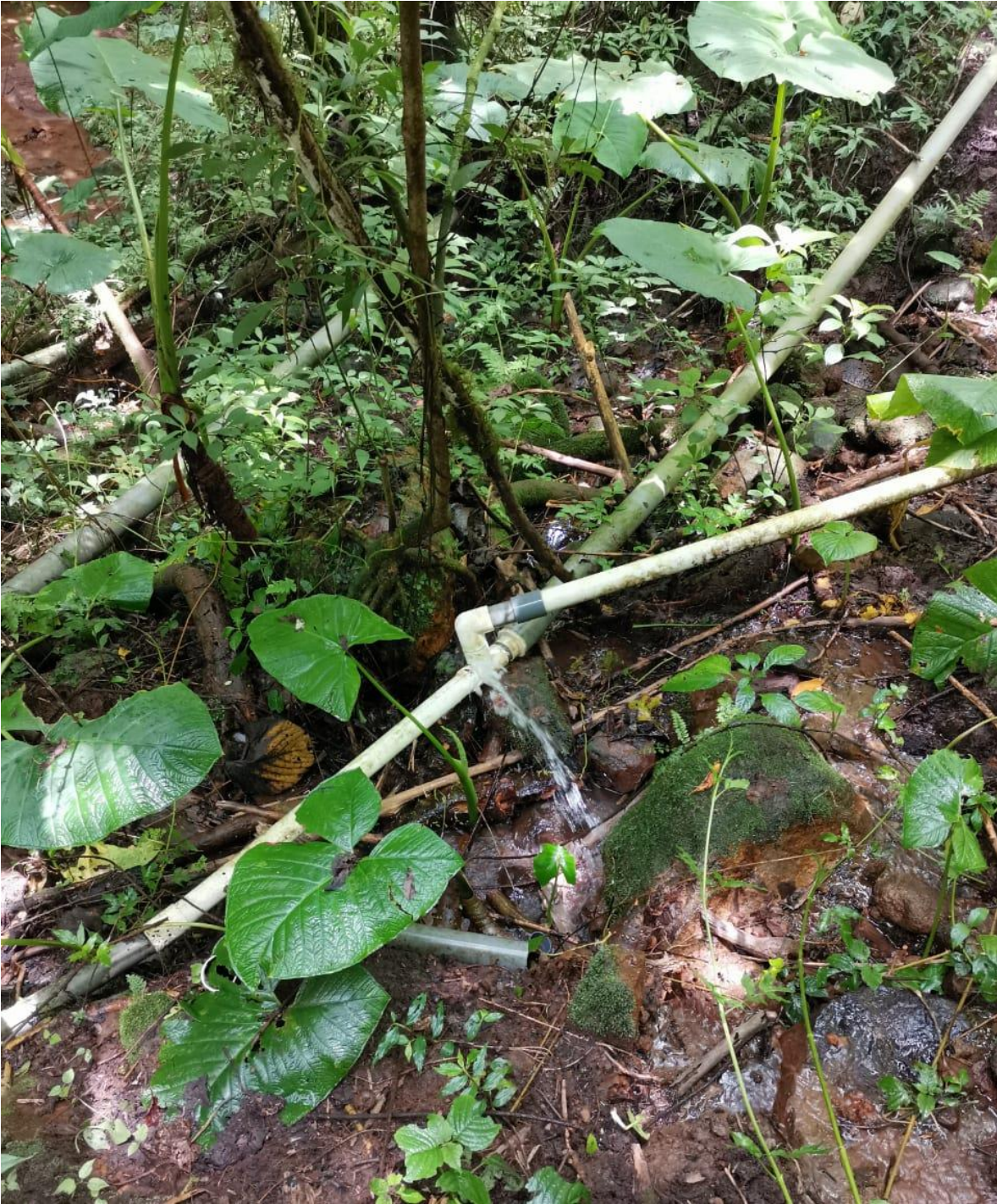
Anexo 25. Captación y aforo El Chayote.
