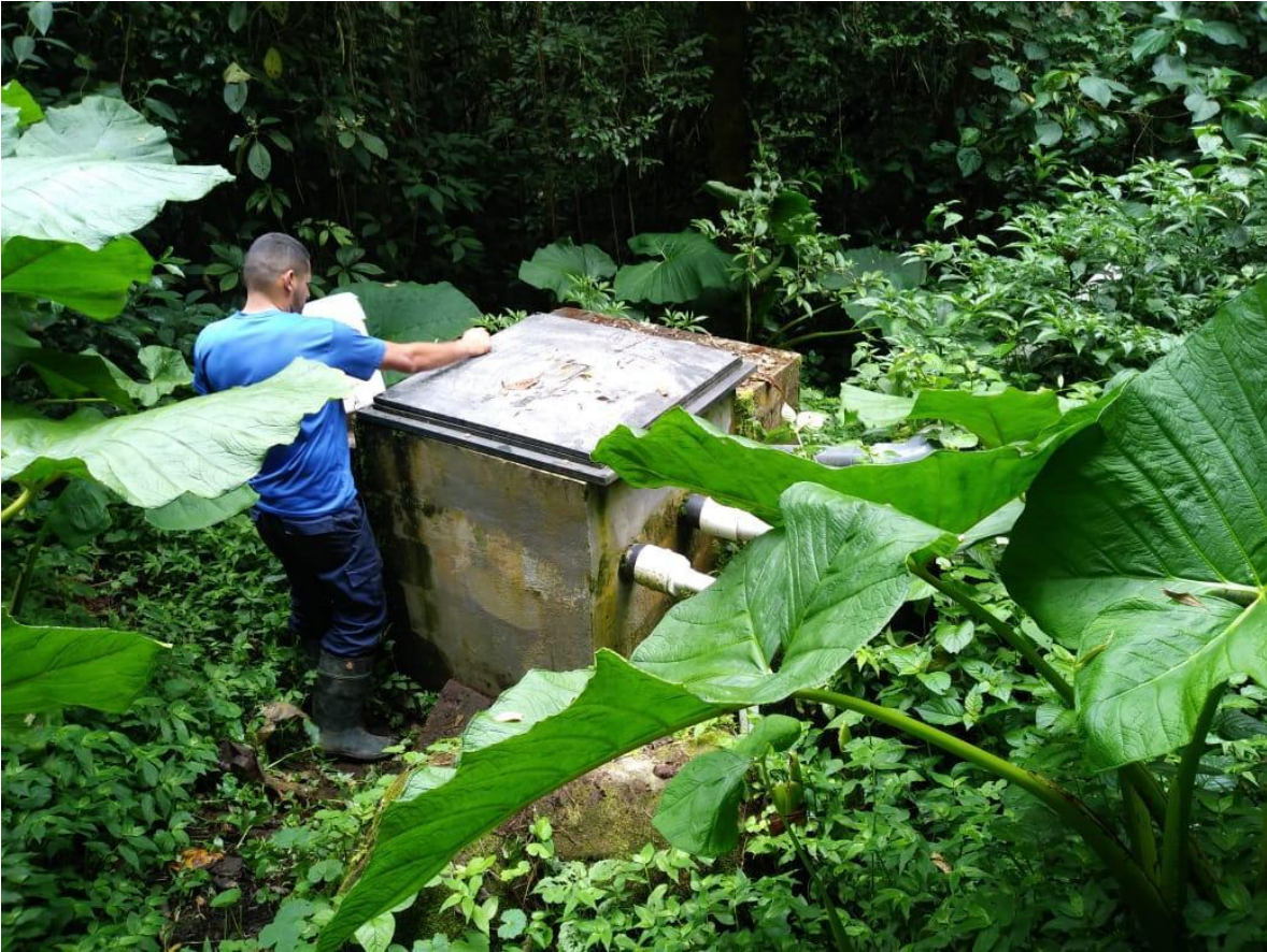
Anexo 24. Captación y Aforo El Chayote
