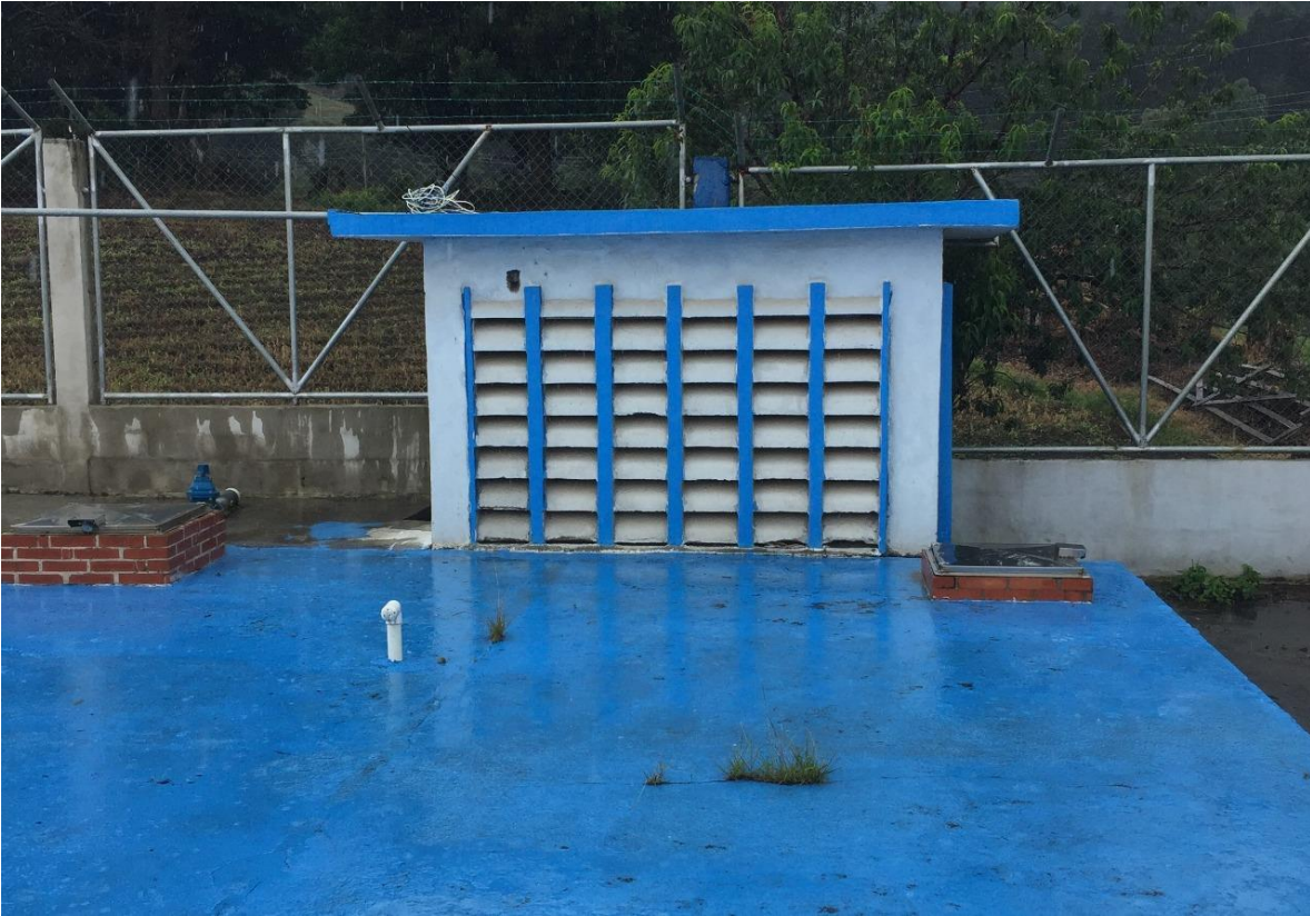
Anexo 14. Tanque Los Gemelos
