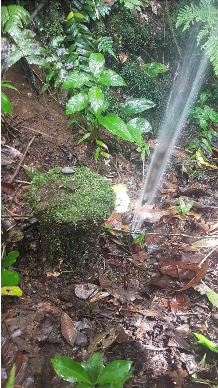
Anexo 11. Revisión de tubería. (Válvula Aire en mal estado)
