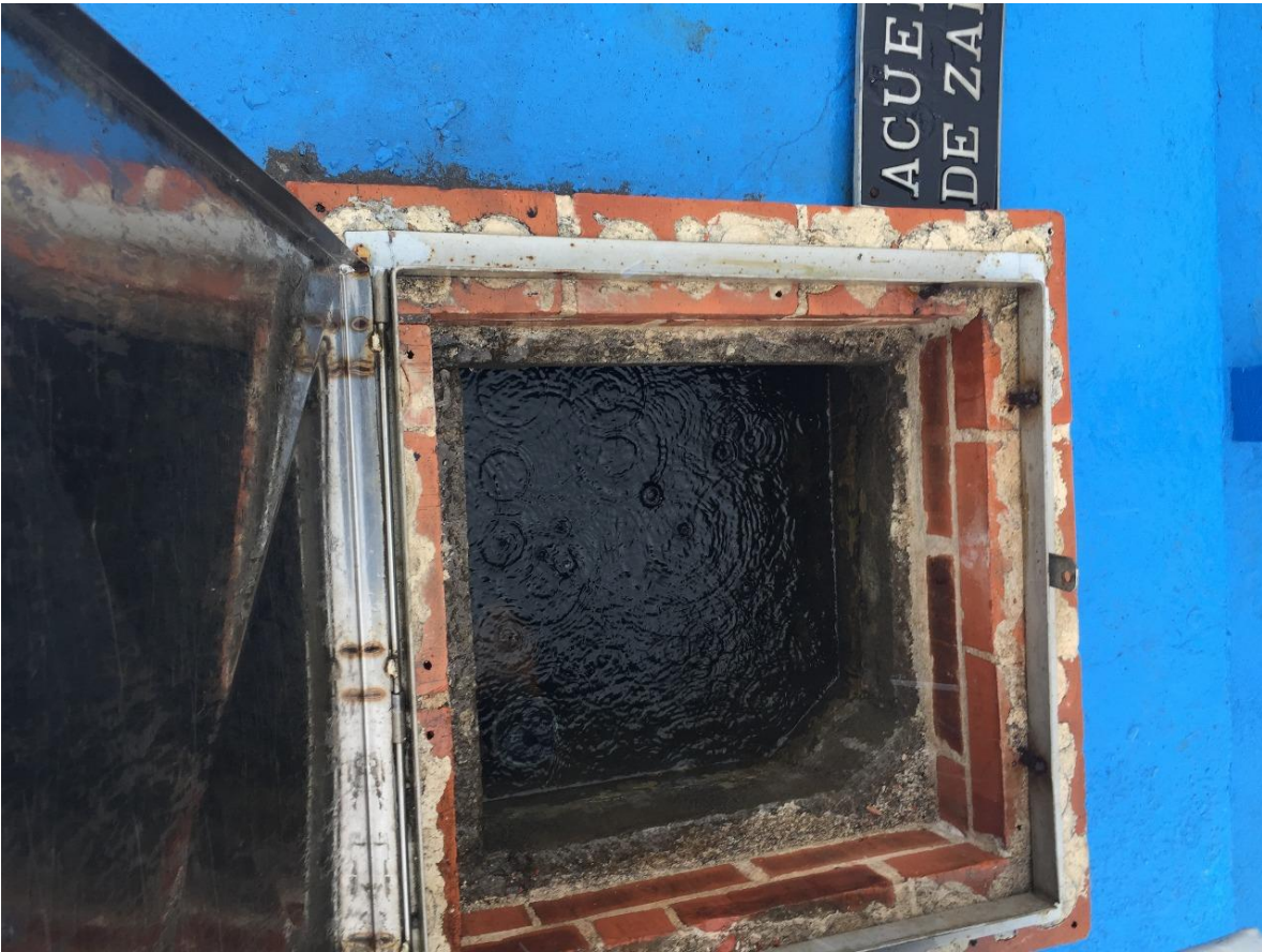
Anexo 15. Tanque Los Gemelos
