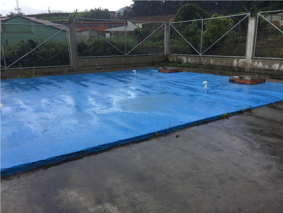
Anexo 13. Tanque Los Gemelos
