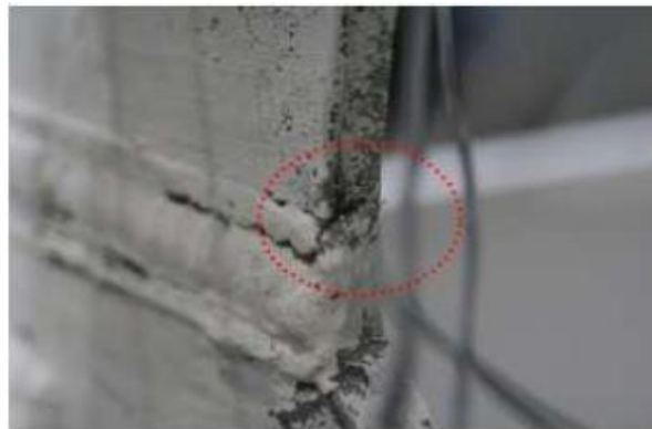
Figura 83. Agrietamiento en soldadura de penetración total en FF-W
