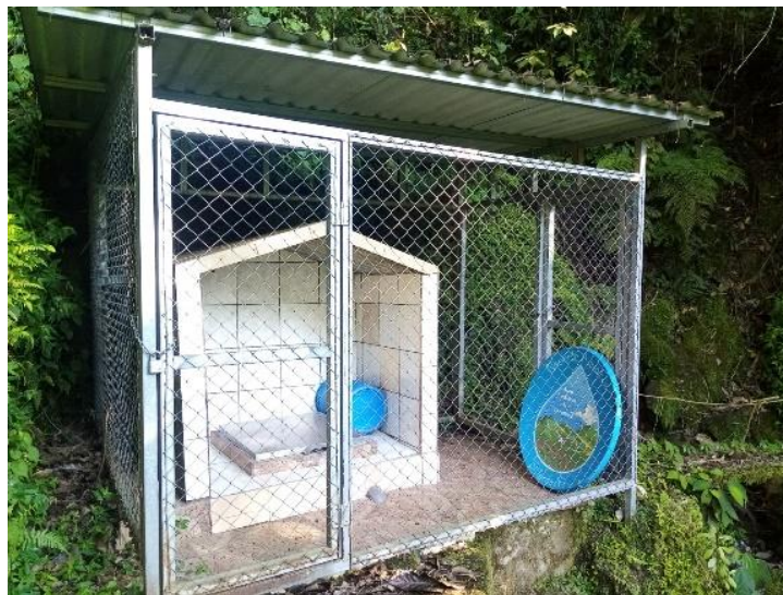
Figura 11 Estructura de captación Agua Fría del sistema #3
