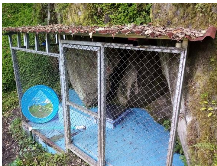
Figura 12 Estructura de captación Manuel Granados del sistema #3
