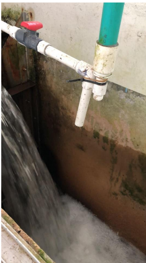
Figura 22 - Punto de aplicación del agente coagulante en el módulo de coagulación de la planta potabilizadora
