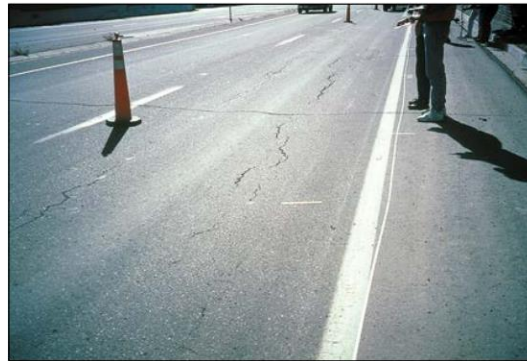
Figura 6. Piel de cocodrilo - severidad baja
