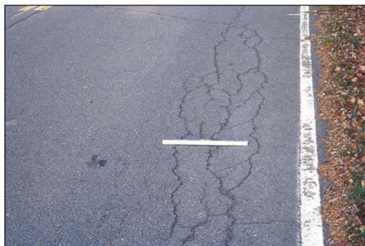
Figura 7. Piel de cocodrilo - severidad media
