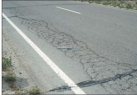
Figura 8. Piel de cocodrilo - severidad alta
