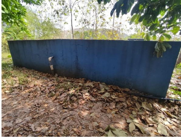
Ilustración 11 Tanque de almacenamiento de agua
