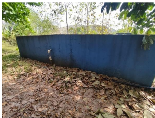
Ilustración 8 Tanque de almacenamiento de agua potable, La Esperanza
