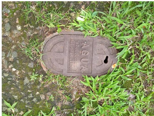
Ilustración 9 Medidor de agua potable
