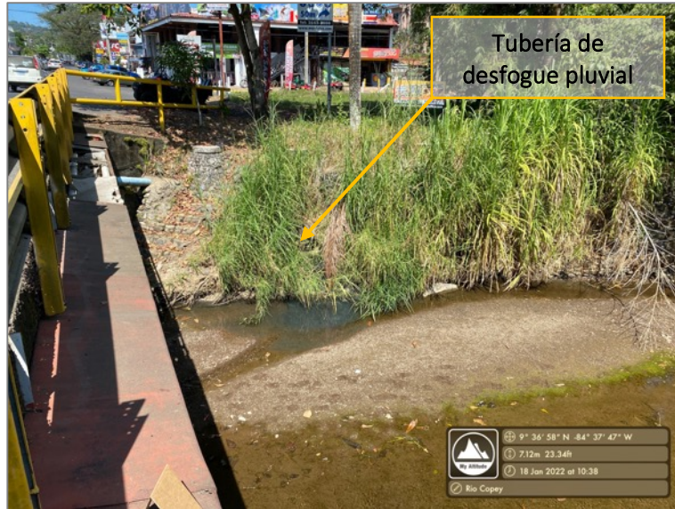
Figura 81. Tubería de desfogue pluvial del Sector Jaco Sol a la base del Río Copey
