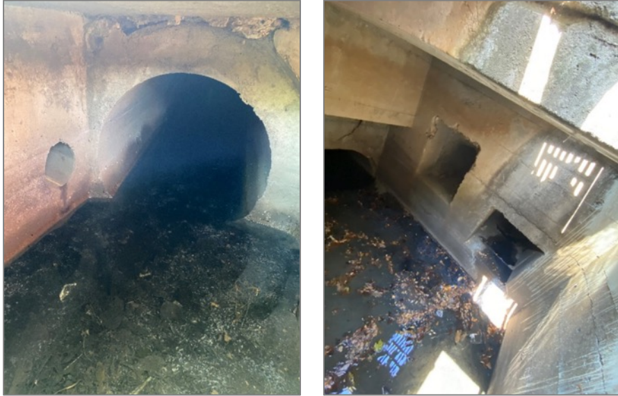
Figura 20. Aguas residuales en alcantarillado pluvial (cajas de registro) sobre Avenida Pastor Díaz. Enero 2021
