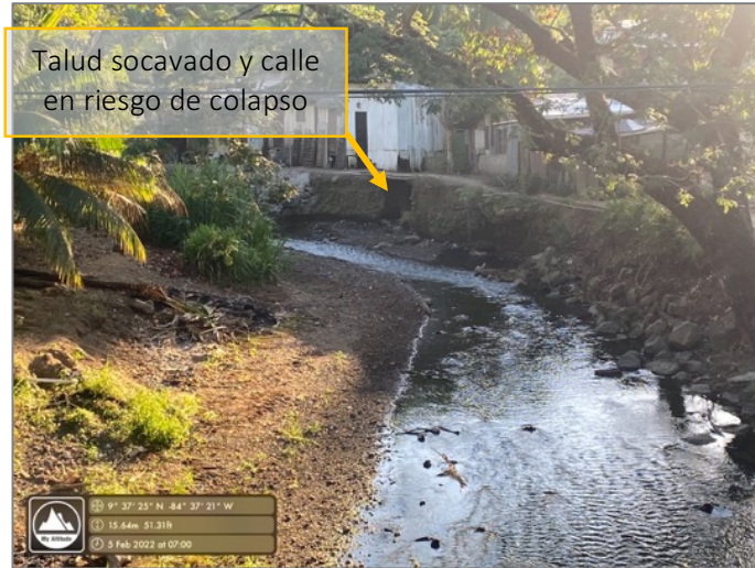
Figura 24. Socavación de la margen derecha del Río Copey en el sector de Barrio Copey, aguas arriba del puente sobre Ruta Nacional N°34. Febrero 2022
