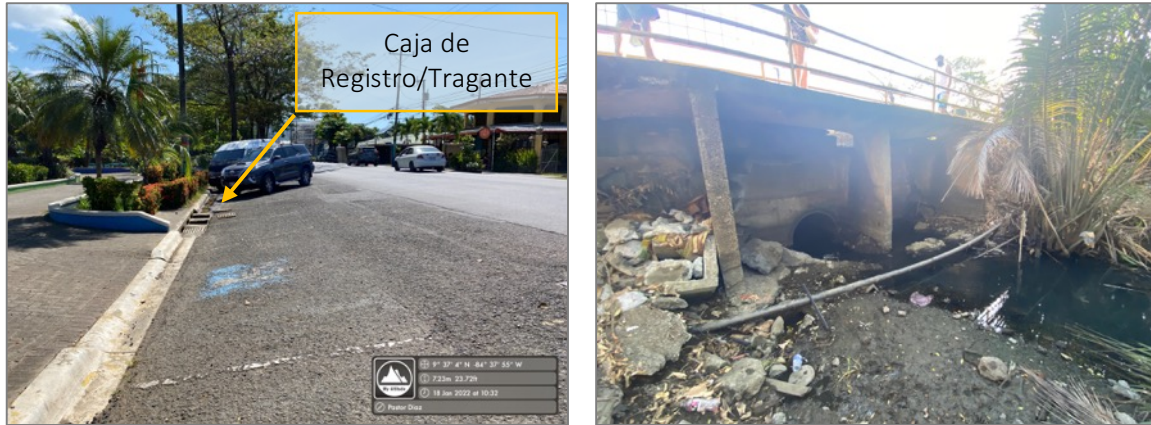
Figura 68. Caja de registro Avenida Pastor Díaz, frente al Parque Johannes Dankers que capta aguas de toda el área tributaria delimitada y vierte a Quebrada Sin Nombre a través de dos tuberías diámetro 700 mm
