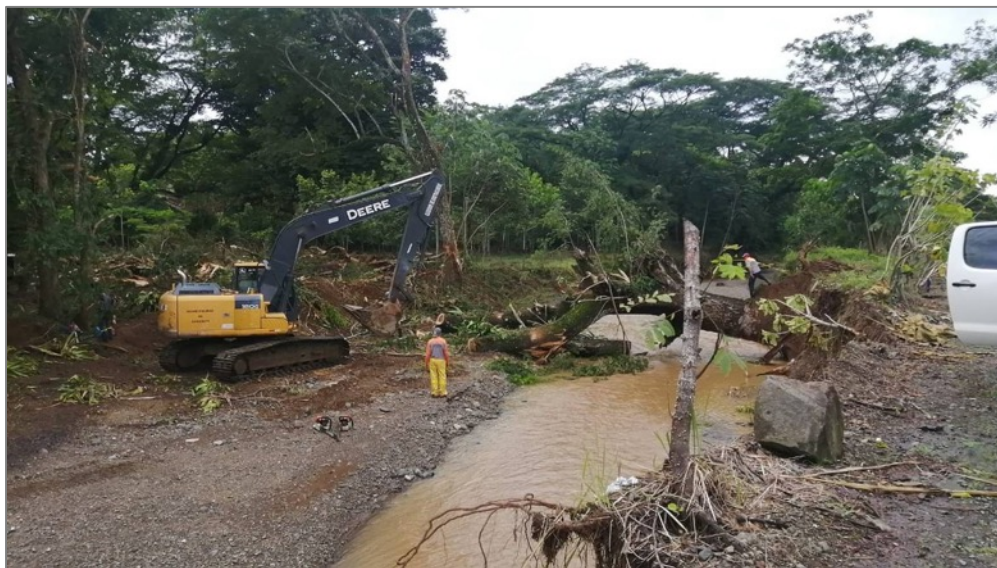
Figura 1. Limpieza del Río Copey posterior a un evento de precipitación extrema. Se observa afectación del bosque ripario por efecto de socavación en la margen. Fuente: La Nación, Agosto 2021
