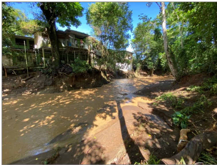
Figura 23. Socavación de la margen derecha del Río Copey en el sector de Barrio Copey, aguas arriba del puente sobre Ruta Nacional N°34. Agosto 2021
