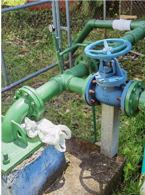
Ilustración 12 Tubería metálica Fuente Propia, 28 de setiembre de 2022
