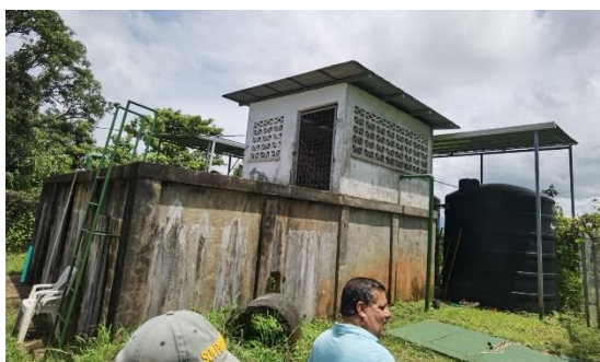
Ilustración 16 Tanque de almacenamiento de agua #1 Fuente Propia, 28 de setiembre de 2022
