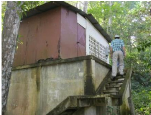
Ilustración 19 Tanque de Captación Fuente Hidrogeotecnia, junio 2013
