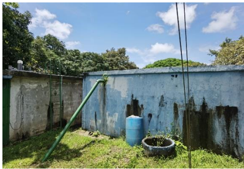
Ilustración 9 Tanque de almacenamiento de agua Fuente Propia, 28 de setiembre de 2022
