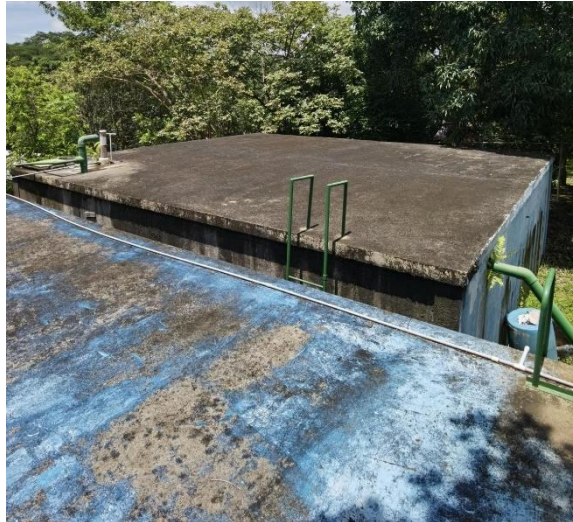
Ilustración 17 Tanque de Almacenamiento #2 Fuente Propia, 28 de setiembre de 2022
