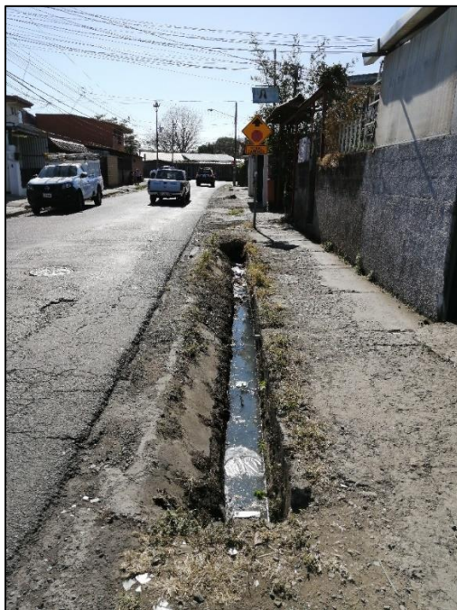
Figura 4 Estancamiento y mala canalización de las aguas en la zona
