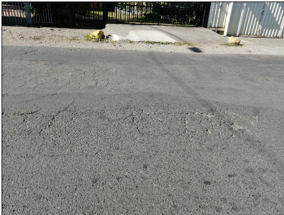
Figura 1 Falla del pavimento por fatiga en la carretera la Plywood.
