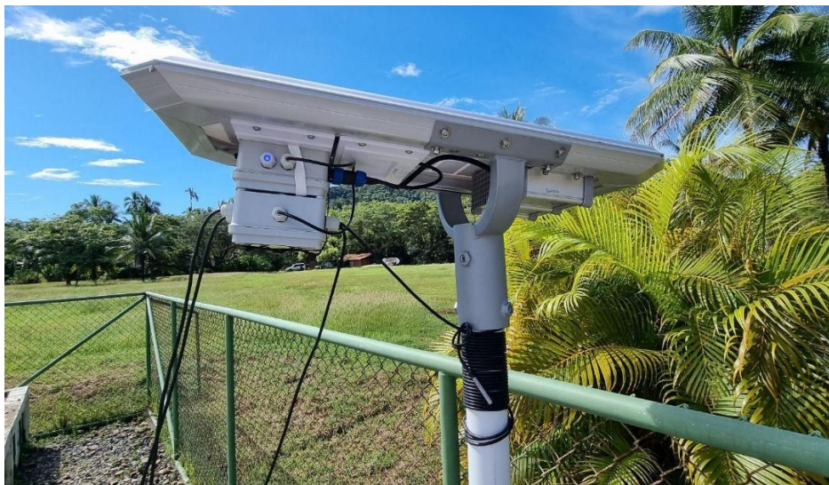
Figura 27: Sistema y Panel Solar con Sensor de Temperatura S1
