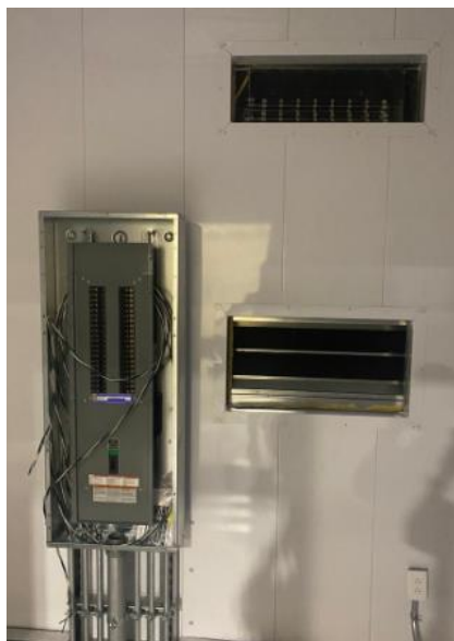
Figura 47: Vista de Panel UPS y Abertura de Aire de Unidad HVAC
