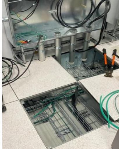
Figura 52: Bandejas Portacables Instaladas
