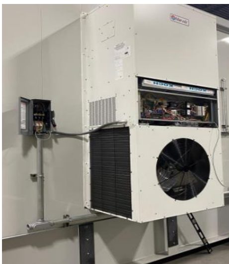
Figura 44: Unidad HVAC y su Desconectador
