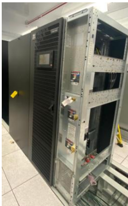
Figura 54: UPS Liebert/Vertiv 30 kW
