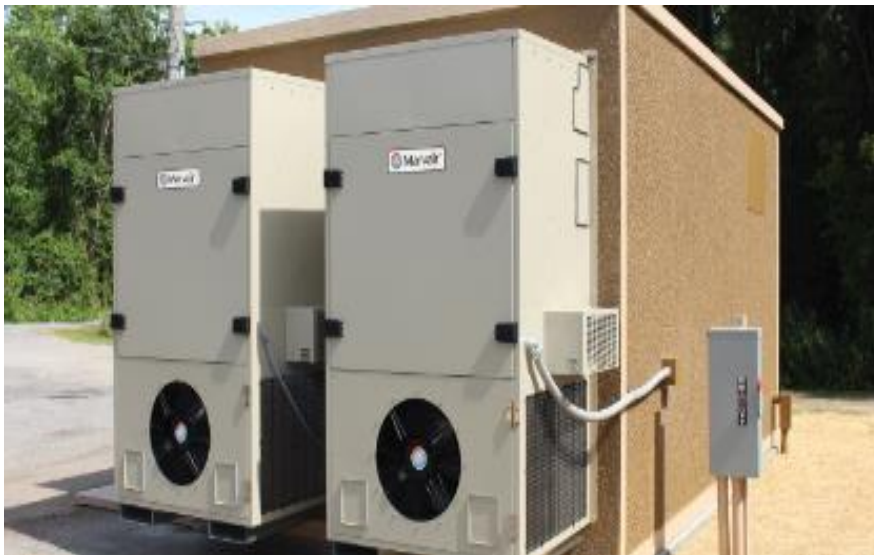
Figura 15: Unidades HVAC Redundantes.
