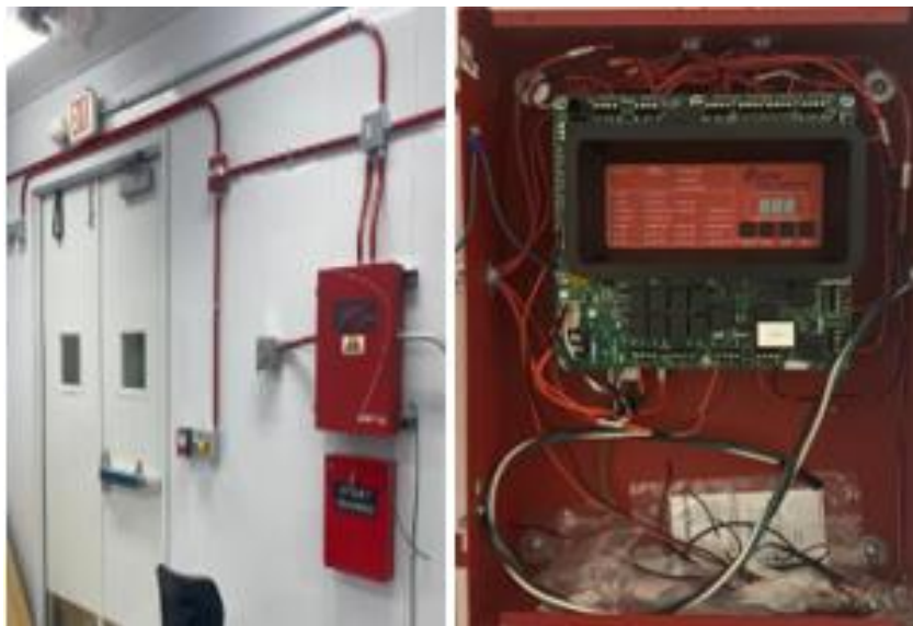
Figura 62: Detalle de Instalación de Sistema de Supresión Contra Incendios
