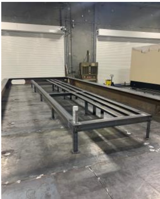
Figura 41: Vista del Sub-piso y de los Soportes de Gabinetes
