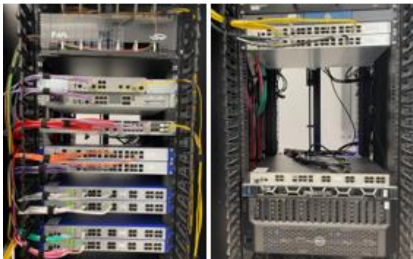
Figura 55: Equipos en Rack de Comunicación
