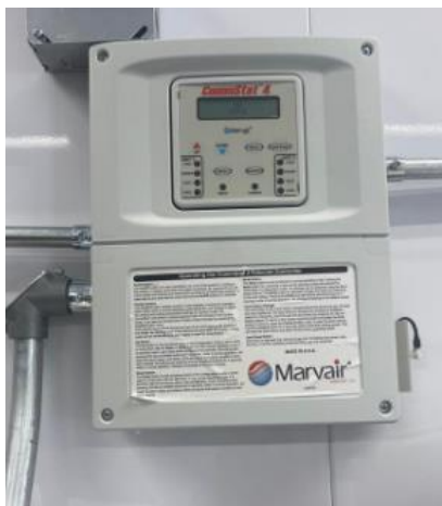
Figura 45: Controlador Para Unidades HVAC
