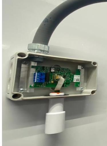
Figura 26: Sensor de Humedad
