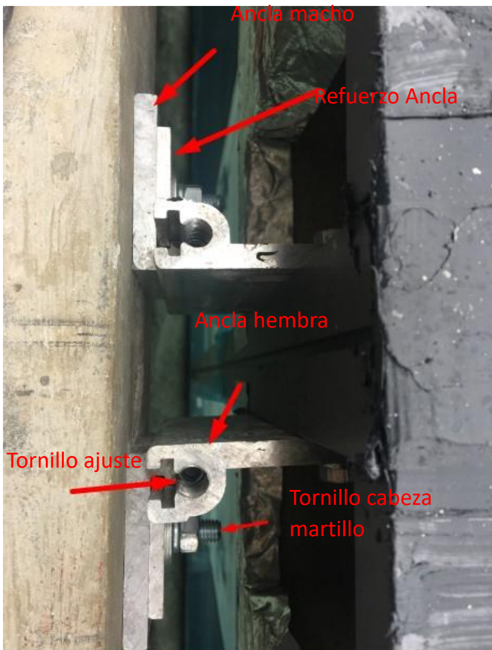
Ilustración 10. Vista del sistema de anclaje armado en sitio.
