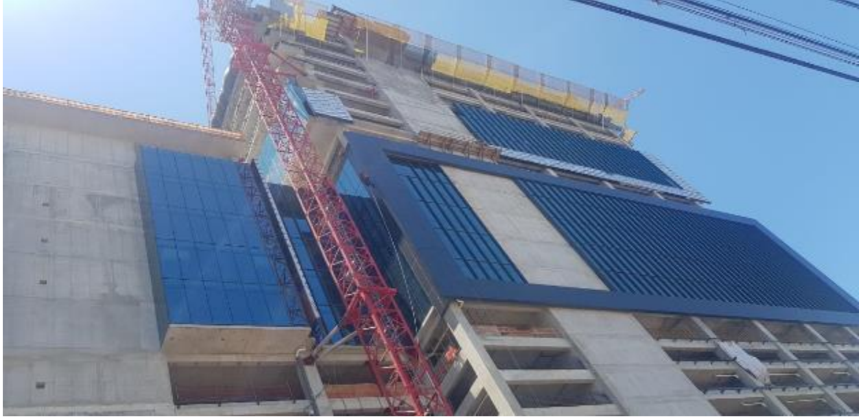
Ilustración 68. Etapas recientes instalación. Fuente: Extralum (2020)
