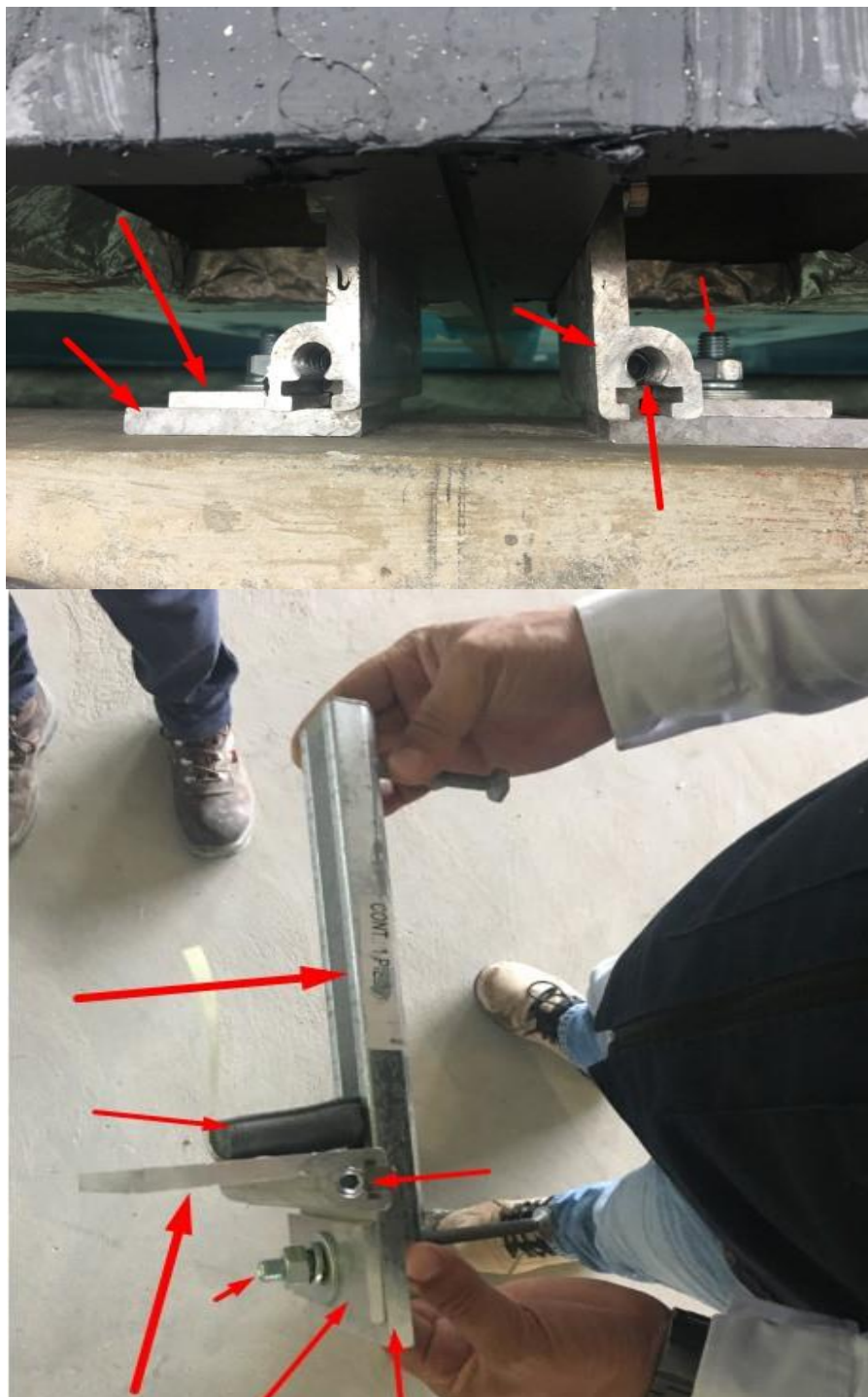
Ilustración 32. Vista de sistema de anclajes.
