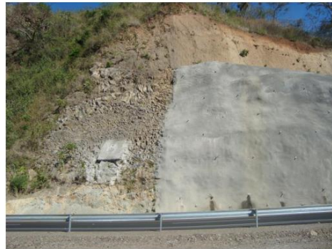
Figura 19: Talud con tratamiento adecuado, pero incompleto
