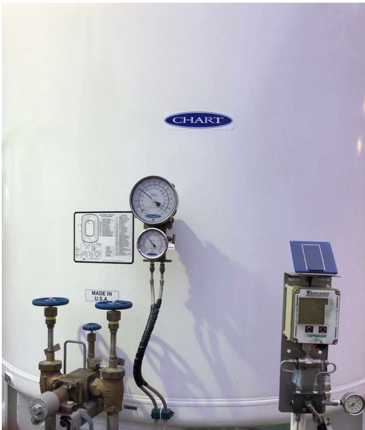
Figura 22. Tanque nitrógeno gaseoso
