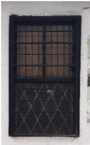
Figura 75 Ventaneria con reja reforzada.
