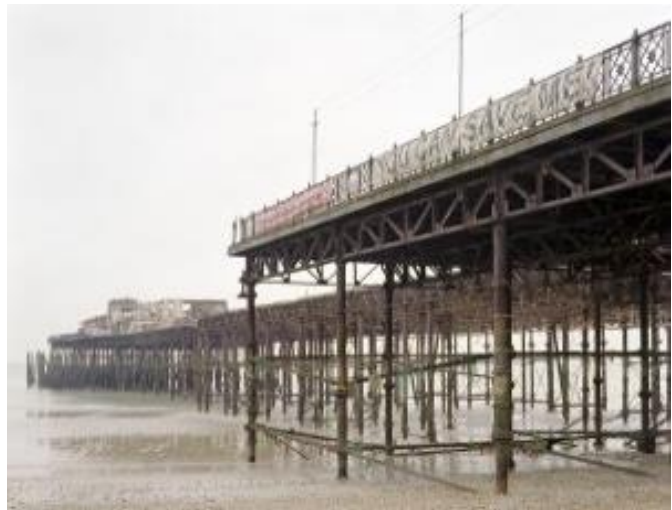
Figura 275. Muelle de Hosting deteriorado por la corrosión Fuente: Simon Robert (2008).
