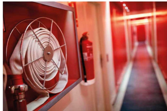
Figura 343. Seguridad contra incendios Fuente: Grupo Prointex (2020)
