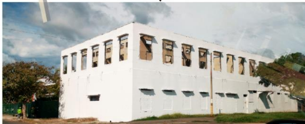
Figura 42 Edificio en Abandono Fuente: Elaboración propia.
