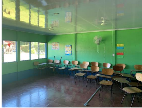
Figura No. 22. Sistemas ventilación Fuente: Elaboración propia.
