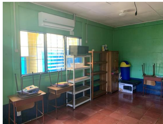
Figura No. 21. Sistemas ventilación. Fuente: Elaboración propia.
