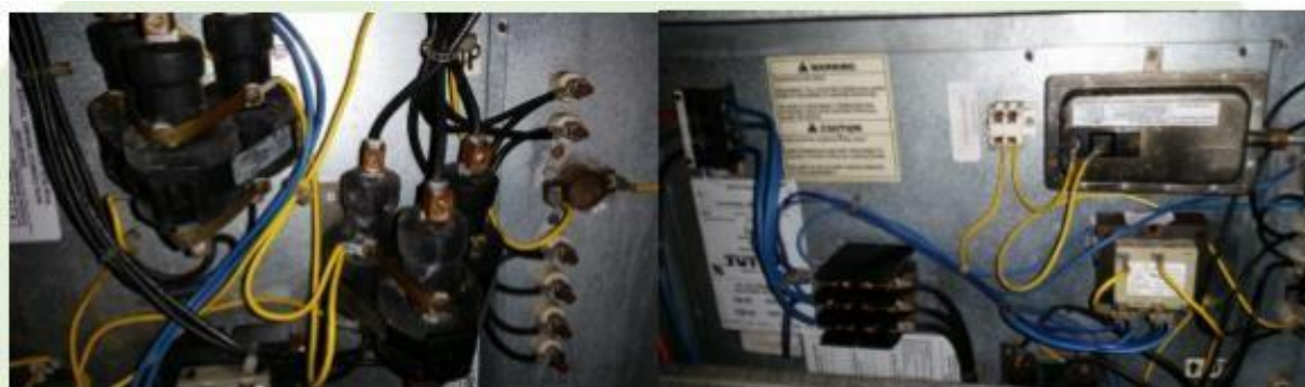
Imagen 13 Condiciones de los equipos
