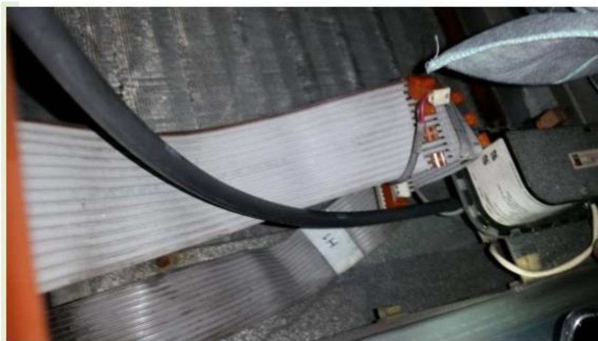
Imagen 14 Condiciones de los equipos
