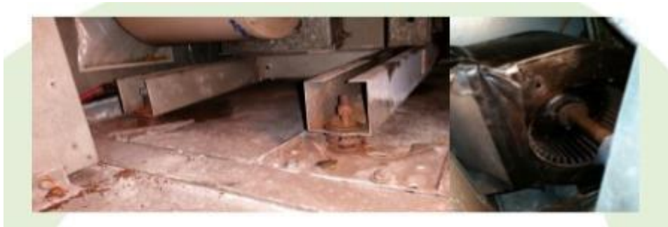
Imagen 3 Condiciones de los equipos
