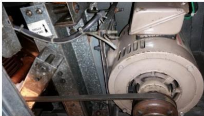
Imagen 15 Condiciones de los equipos
