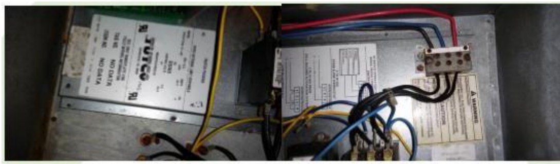
Imagen 21 Condiciones de los equipos
