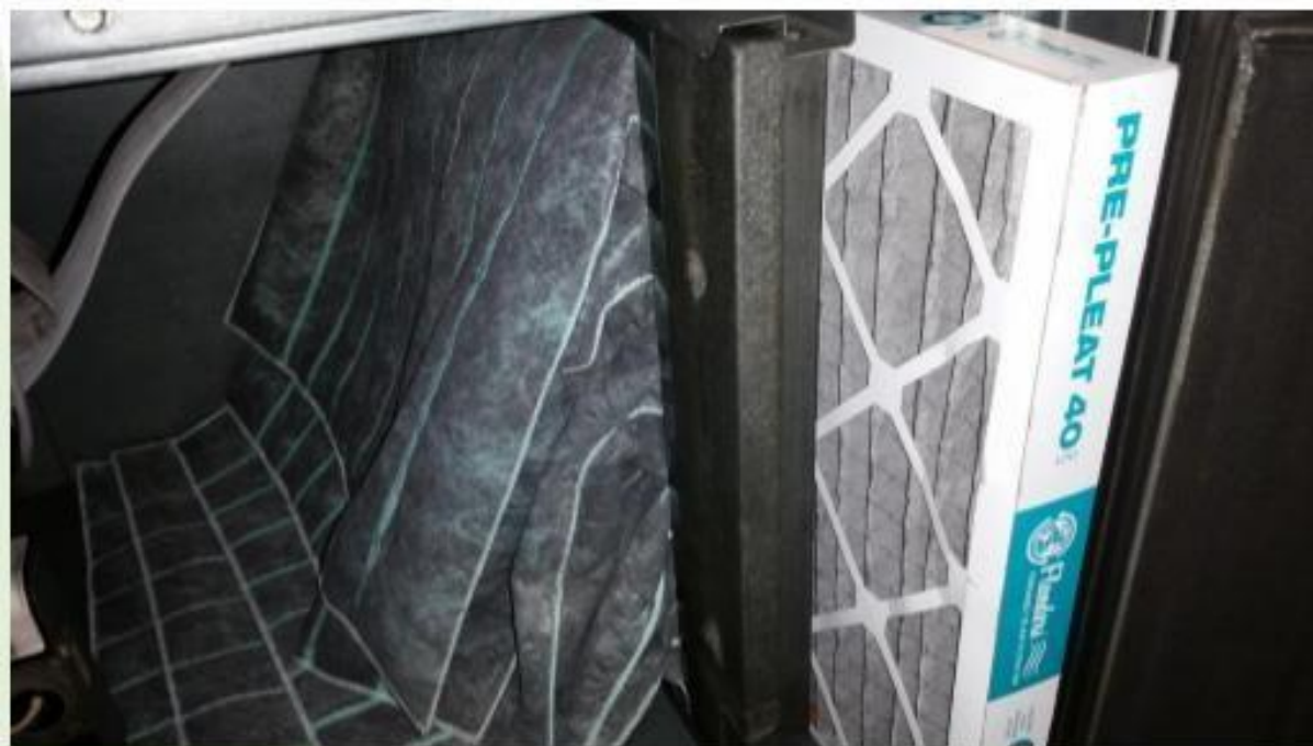
Imagen 12 Condiciones de los equipos
