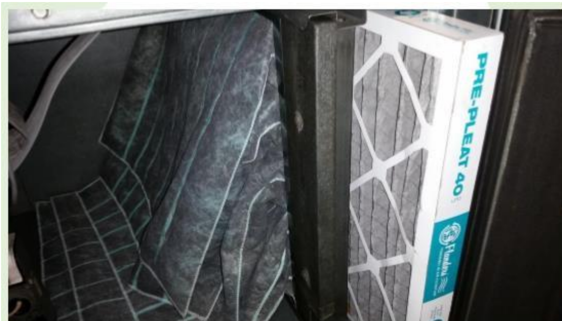
Imagen 19 Condiciones de los equipos
