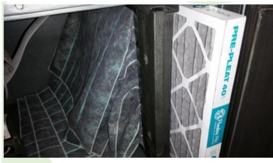
Imagen 6 Condiciones de los equipos
