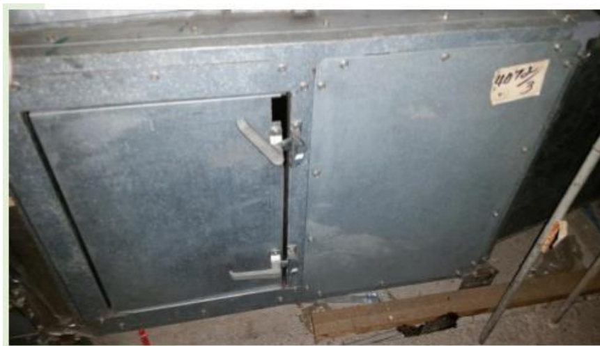
Imagen 20 Condiciones de los equipos
