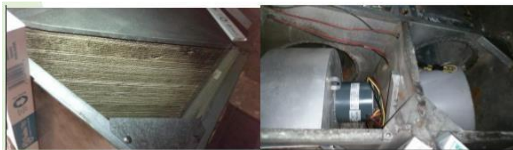
Imagen 10 Condiciones de los equipos
