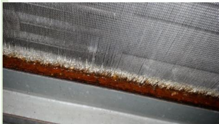
Imagen 8 Condiciones de los equipos
