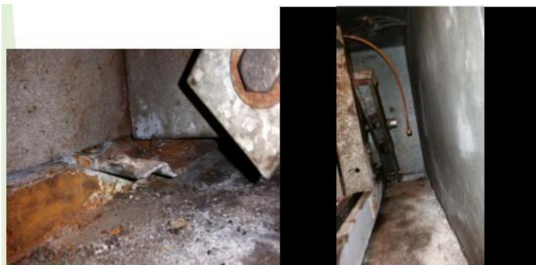
Imagen 16 Condiciones de los equipos
