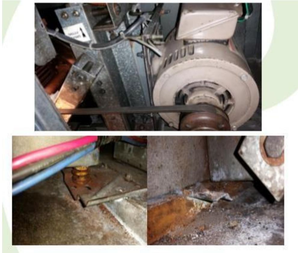
Imagen 2 Condiciones de los equipos
