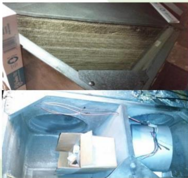
Imagen 4 Condiciones de los equipos
