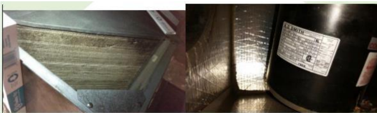
Imagen 17 Condiciones de los equipos
