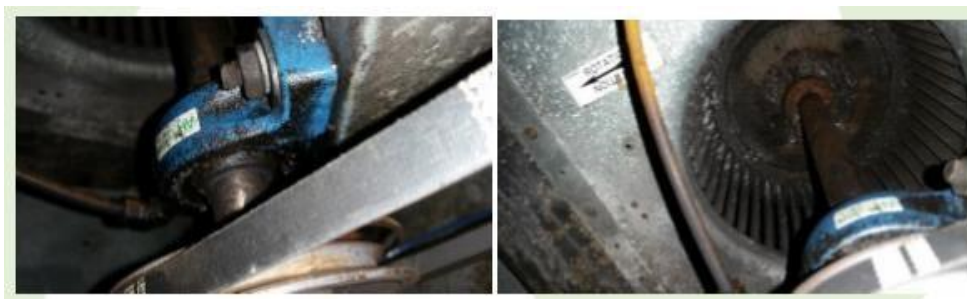
Imagen 9 Condiciones de los equipos
