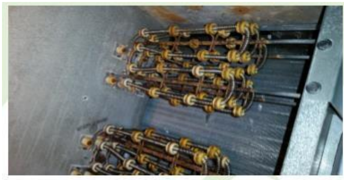
Imagen 5 Condiciones de los equipos
