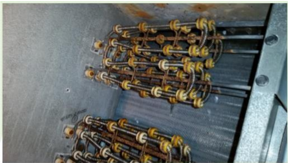
Imagen 11 Condiciones de los equipos
