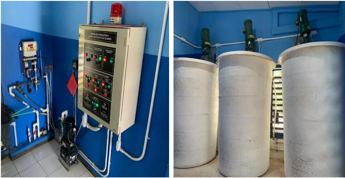
Figura 29 Estructura Caceta Control de Sulfato
