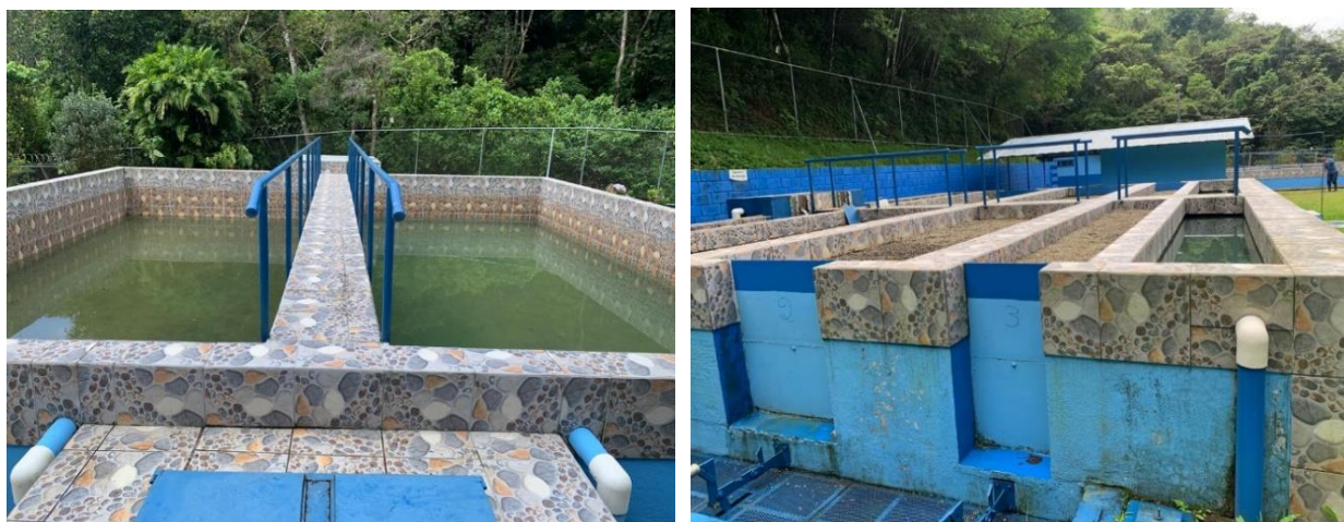
Figura 19 Estructura Planta de Tratamiento Tarbaca
