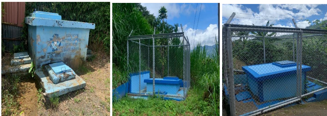
Figura 26 Estructuras Tanques Quiebra gradientes
