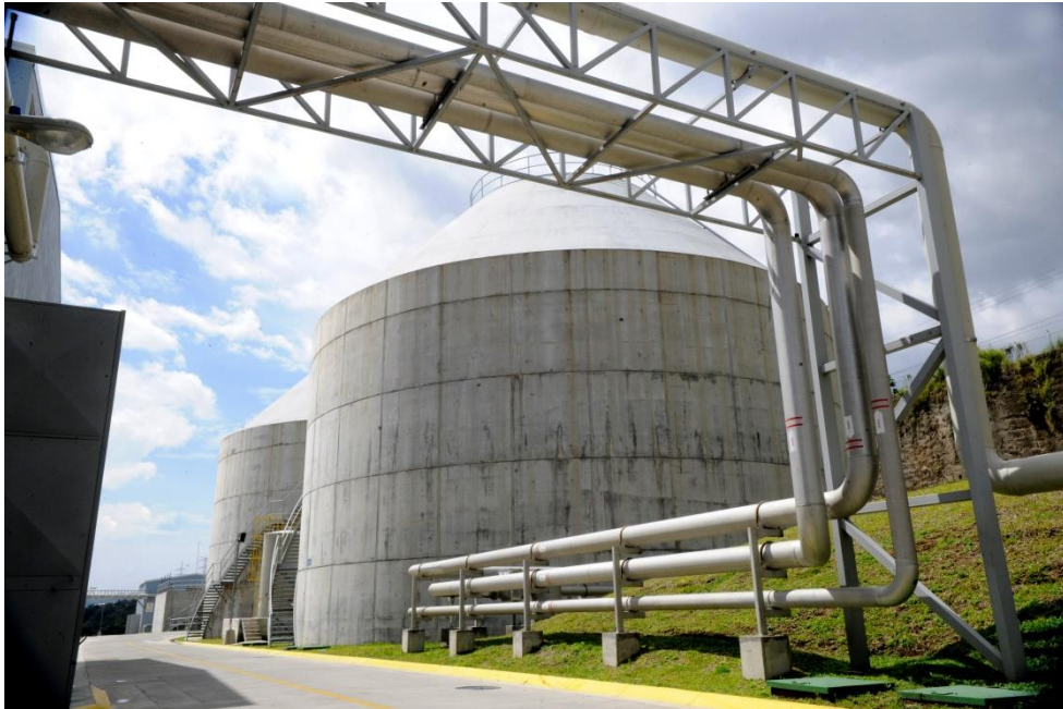
Figura N° 5: Planta de tratamiento de aguas residuales
