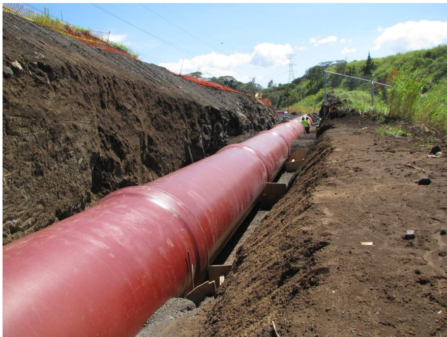
Figura N° 6: Tuberías donde se transportan las aguas residuales
