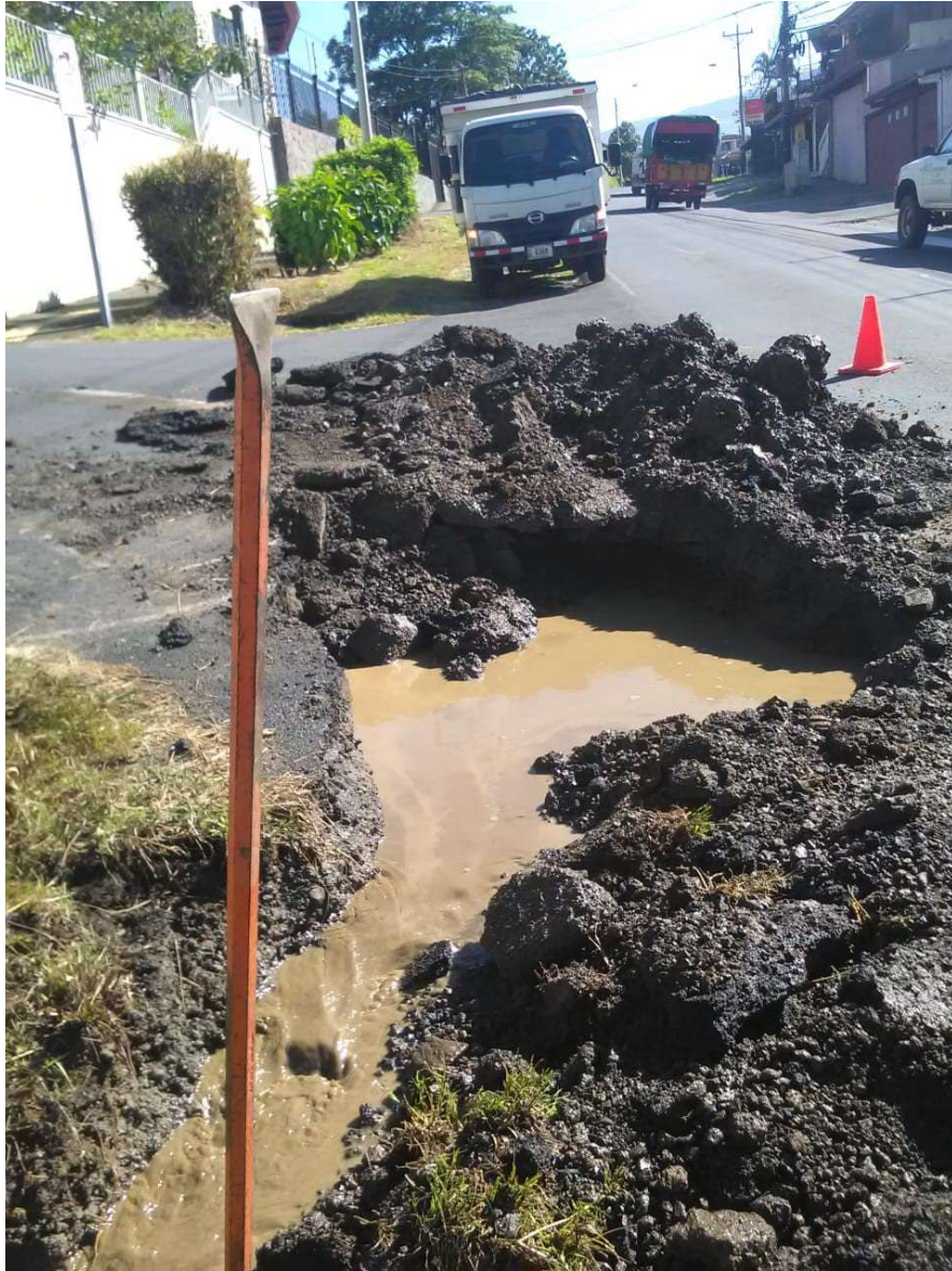
Ilustración 40: Daño en tubería
