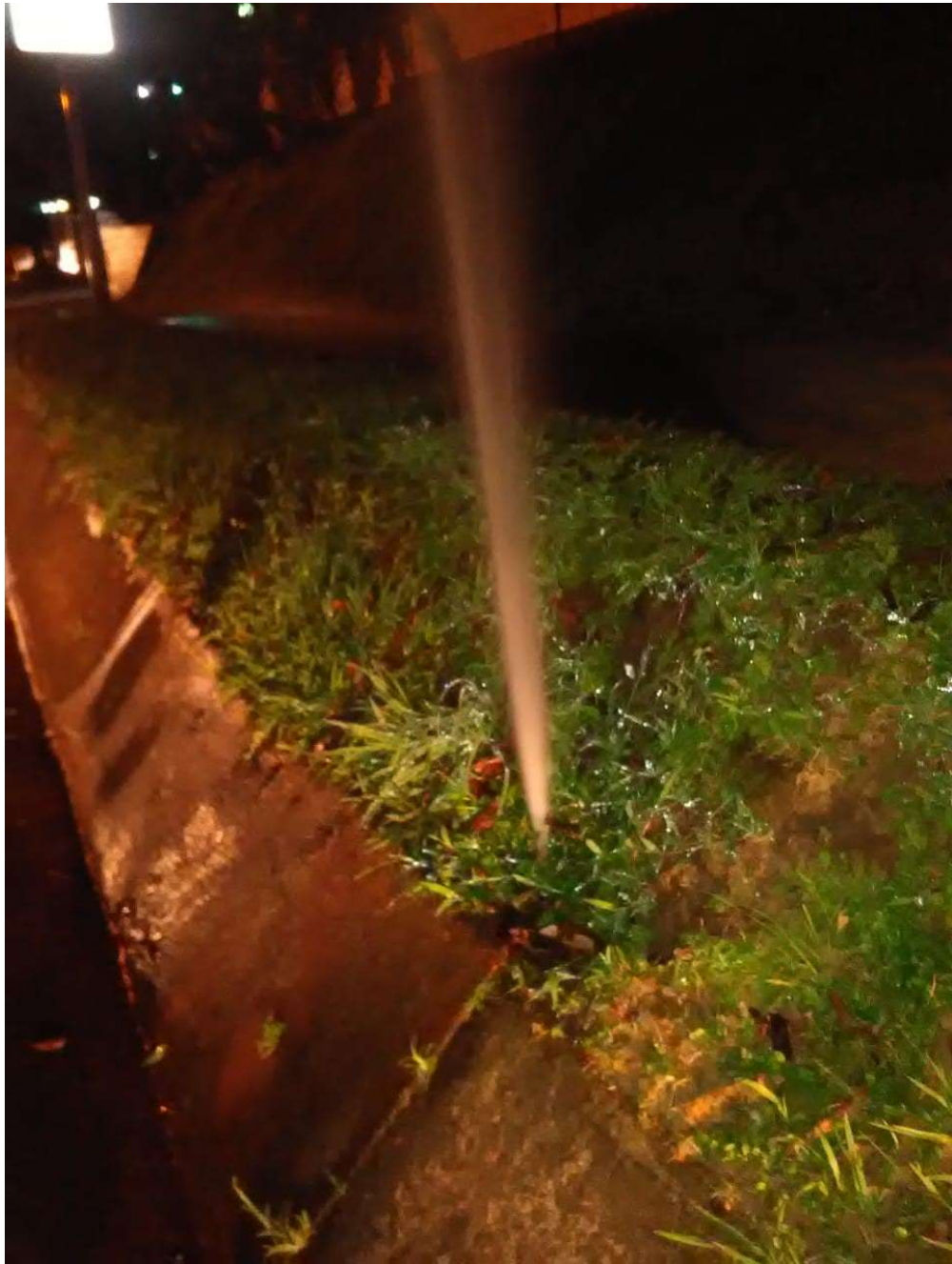
Ilustración 41: Fuga en el sector de La Ceiba
