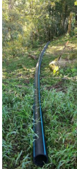
Figura. 7. Tubería PEAD línea de conducción.
