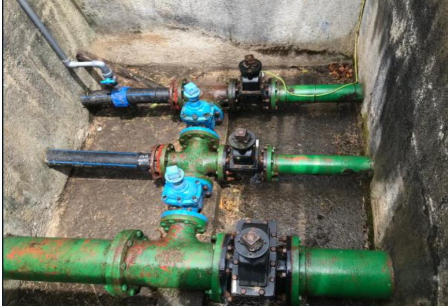
Figura. 38. By-pass en tanque de almacenamiento.
