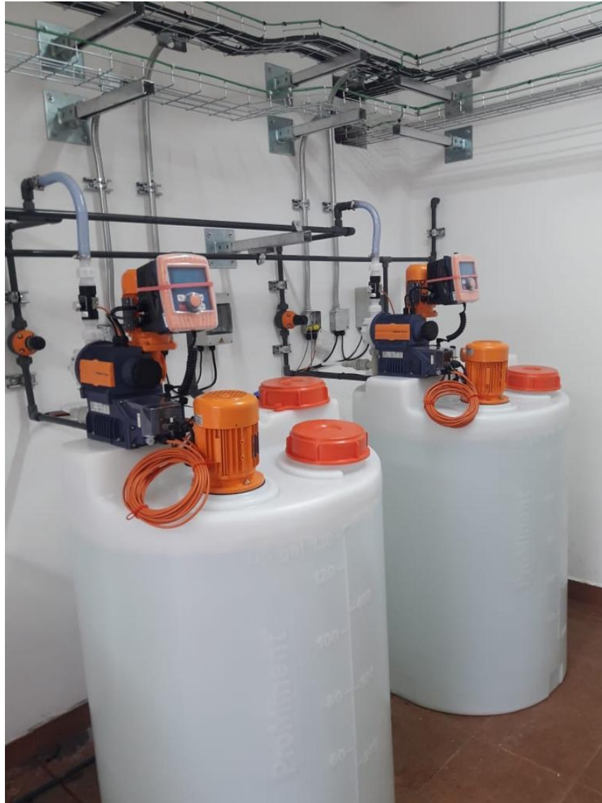
Figura. 19. Sistemas de coagulación y floculación (Dosificadores).
