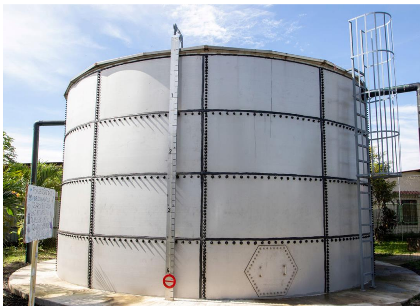
Figura. 10. Tanque de almacenamiento en Acero Inoxidable.
