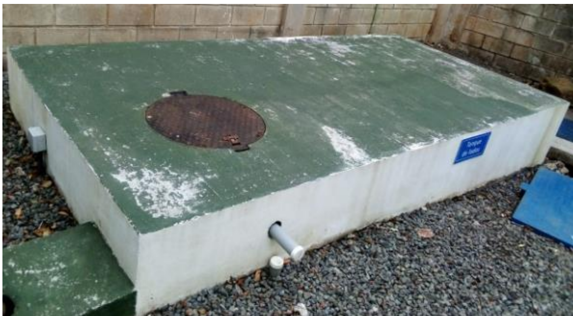
Figura. 41. Tanque para almacenamiento de lodos producidos en la planta.
