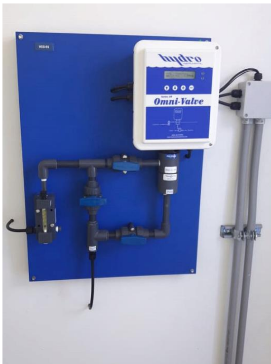
Figura. 17. Sistema de cloración por dosificación.
