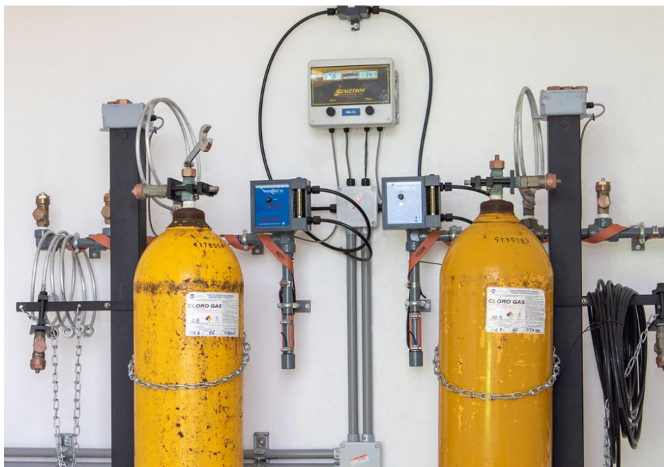
Figura. 18. Sistema de cloración por cloro gas.
