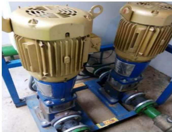
Figura. 42. Bombas de impulsión.
