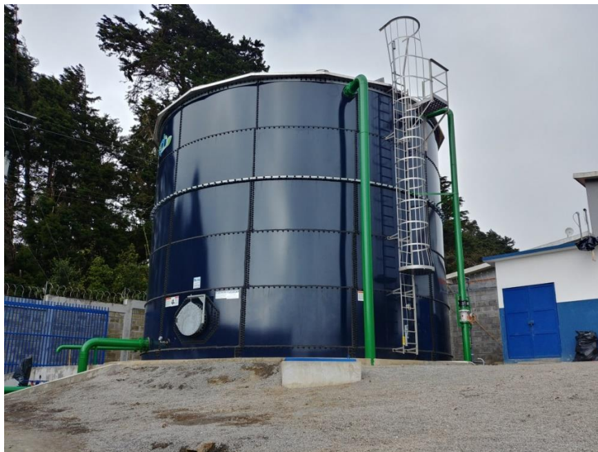
Figura. 9. Tanque de almacenamiento en acero vitrificado.
