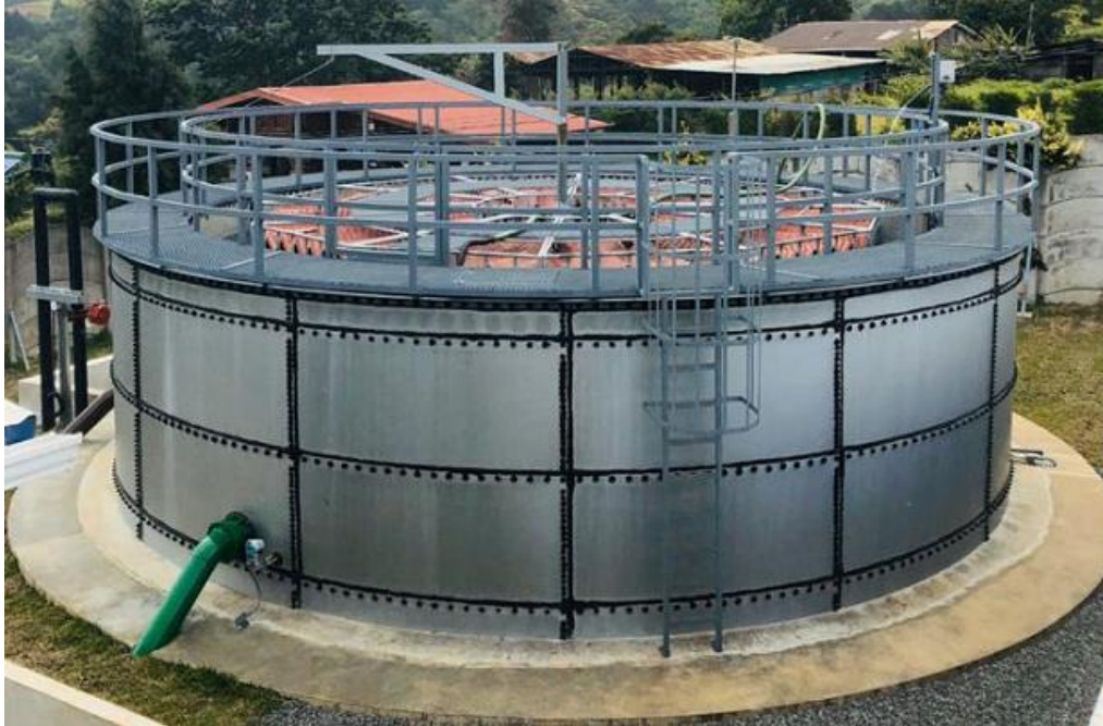
Figura. 15. Vista frontal del clarificador.
