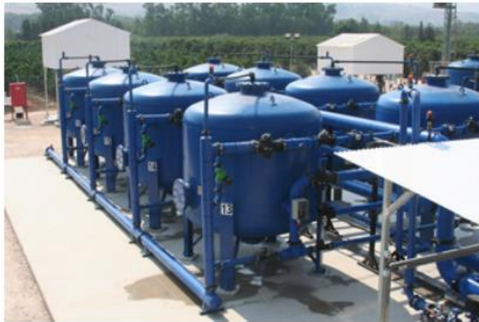
Ilustración 24 Planta Potabilizadora de Israel
