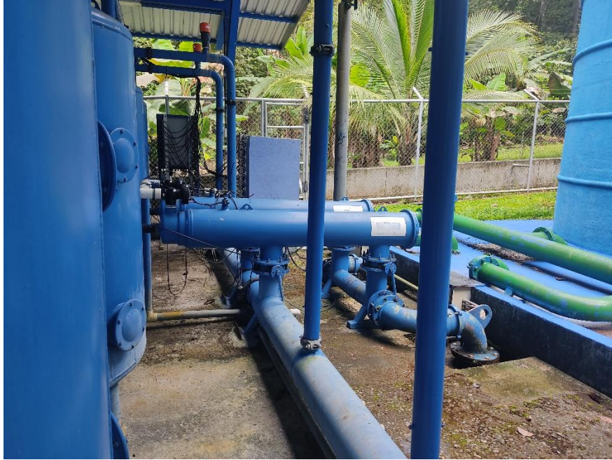
Ilustración 21 Proceso de Prefiltración.
