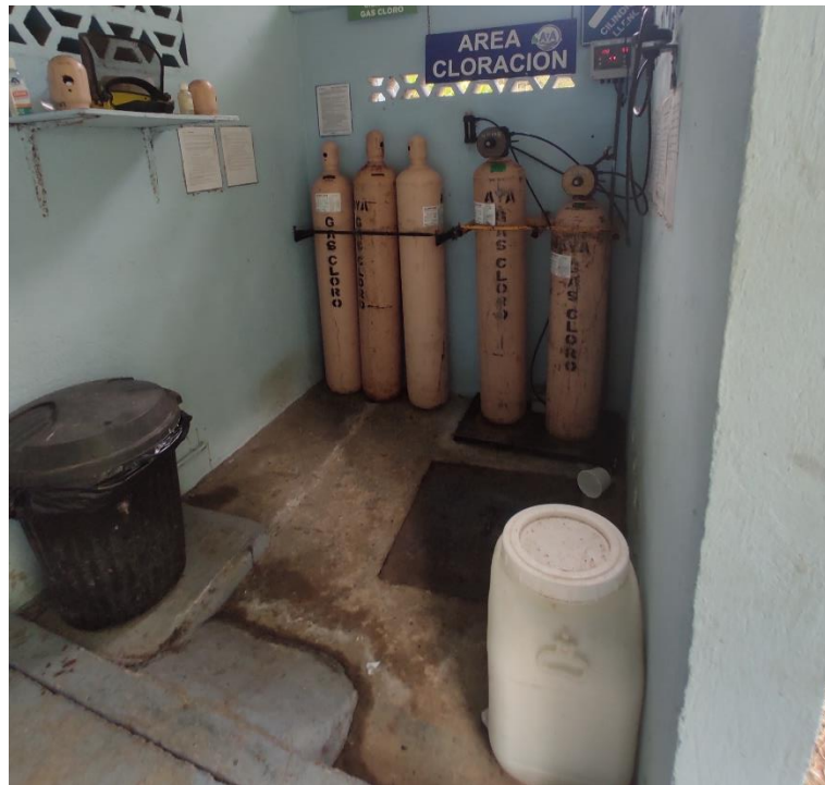
Ilustración 20 Proceso de Cloración
