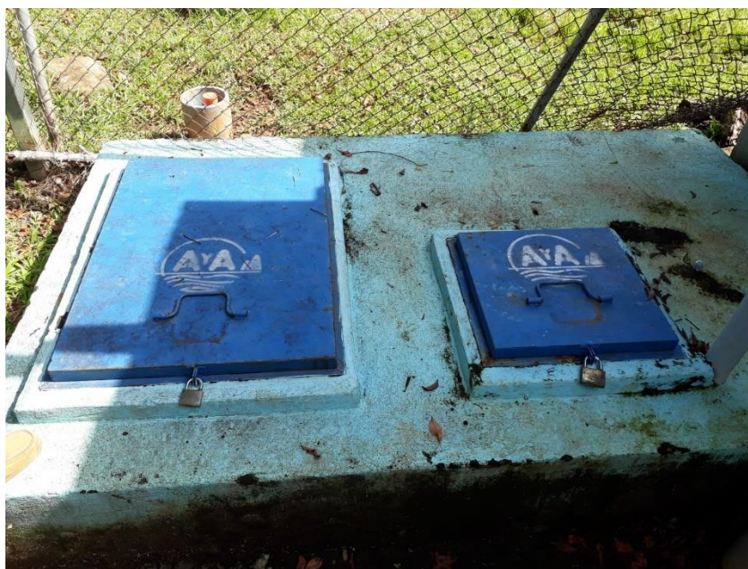
Figura 12: Caja de válvulas de control y punto de aplicación de soda cáustica al 50%
