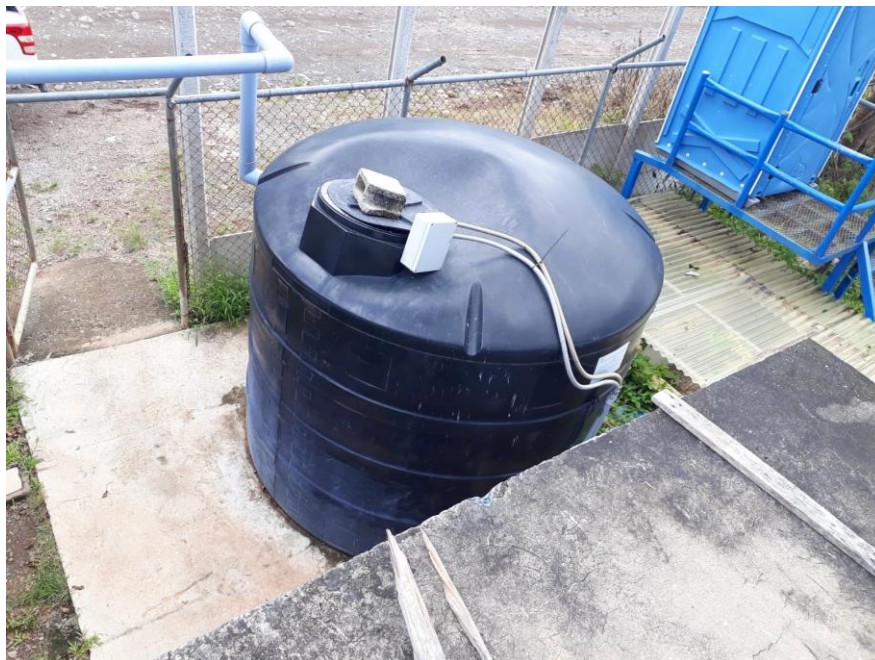
Figura 6: Tanque de Bombeo, con una capacidad de 6000 litros
