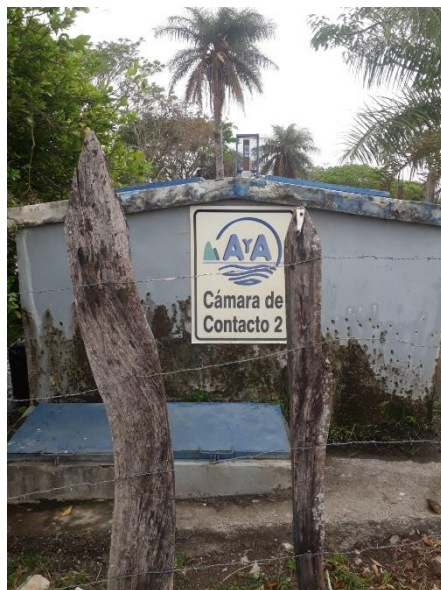
Figura 17 Daños en estructura de cámara de contacto 2
