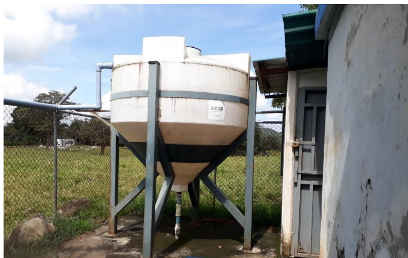
Figura 8: Tolva de recepción de agua de lavado de los tanques presurizados
