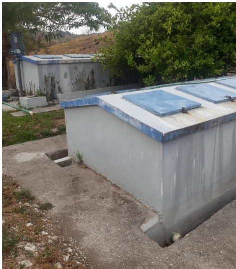
Figura 16 Estado de Cámaras de contacto 1 y 2
