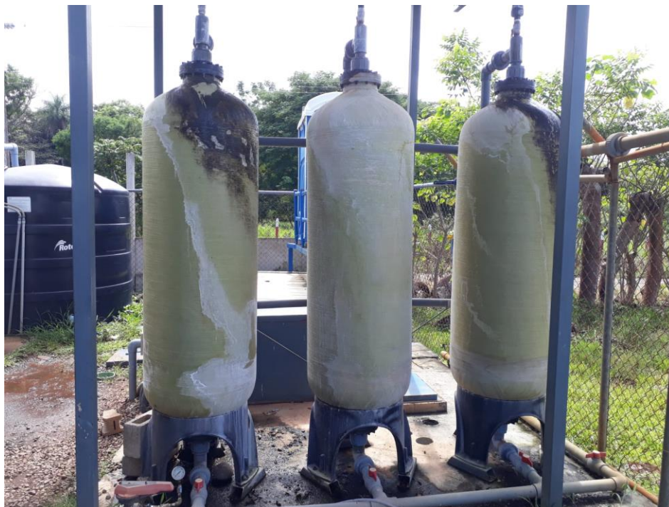
Figura 5 Filtros presurizados, cuenta con tres unidades y válvulas en la entra así como en la salida
