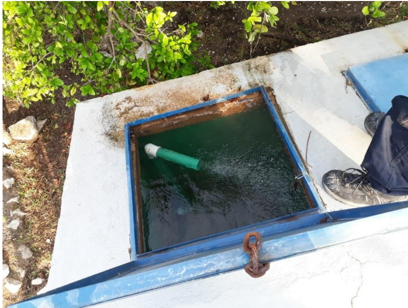
Figura 19 Ingreso agua cruda a la cámara de contacto 2
