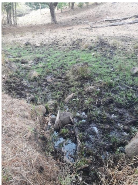
Figura 30 Fuga 1 de tubería que conduce agua de las cámaras de contacto a la planta potabilizadora
