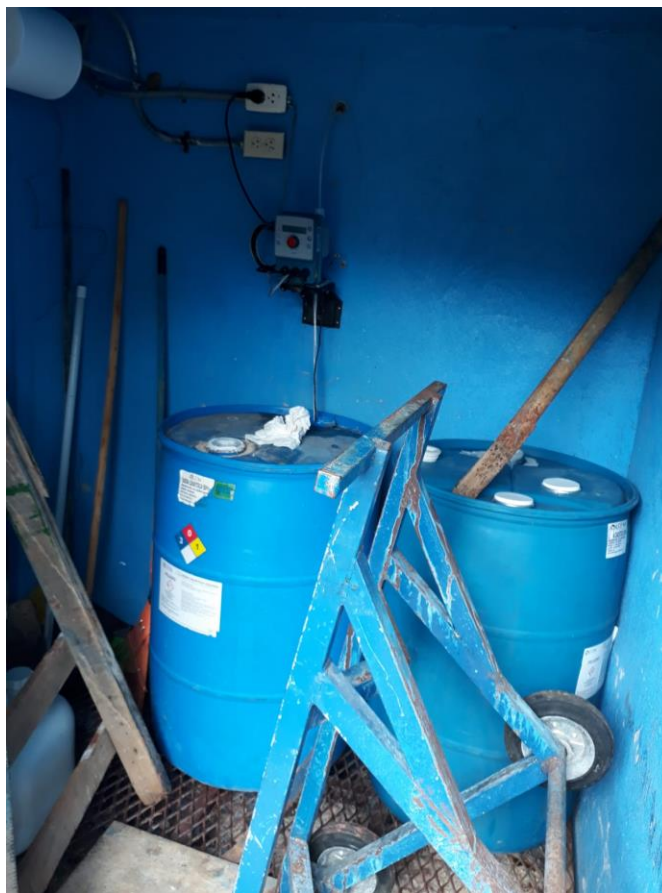
Figura 9: Caseta de almacenamiento de soda cáustica al 50% y bomba dosificadora
