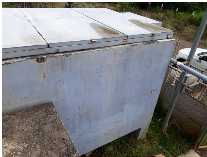
Figura 14: Tanque floculador sedimentador ascendente de concreto reforzado con acero estructural
