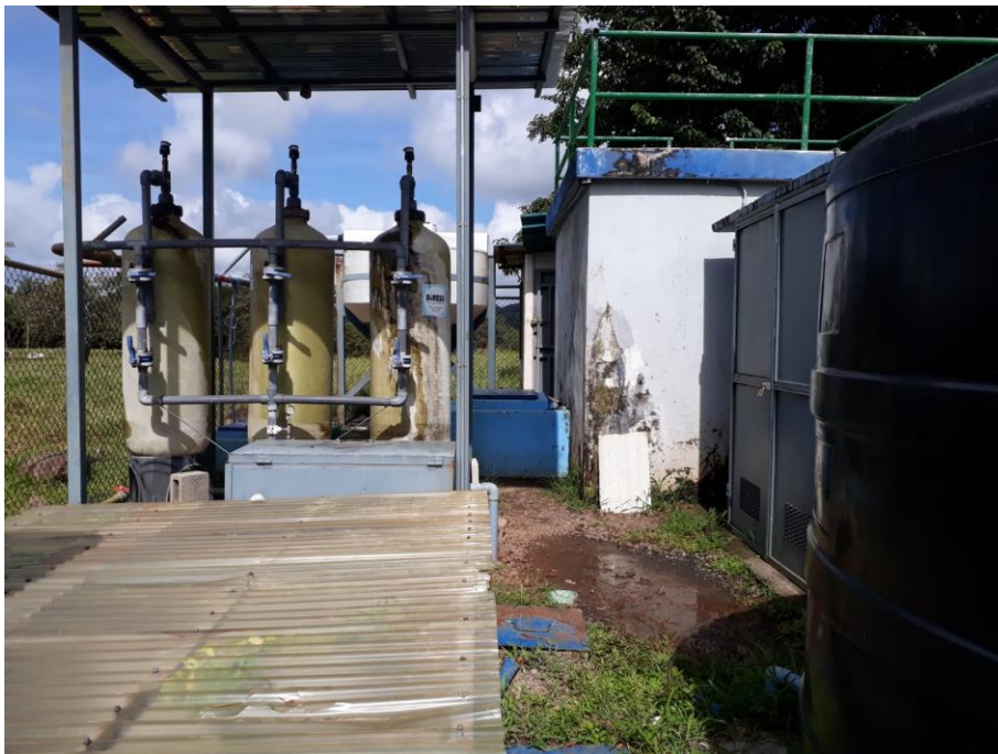
Figura 13: Lechos de secado, filtros presurizados y tanque de almacenamiento
