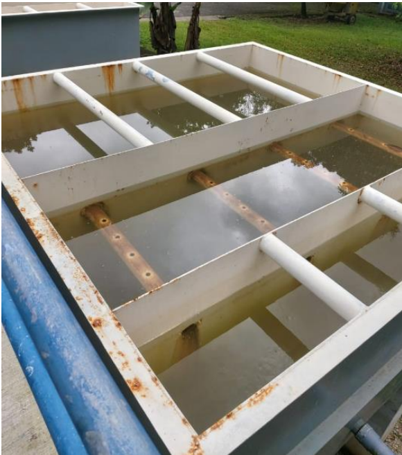
Módulos donde ocurre la floculación y sedimentación.
