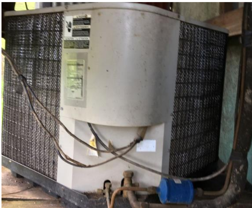
Figura No. 20: Compresor del sistema principal de enfriamiento
