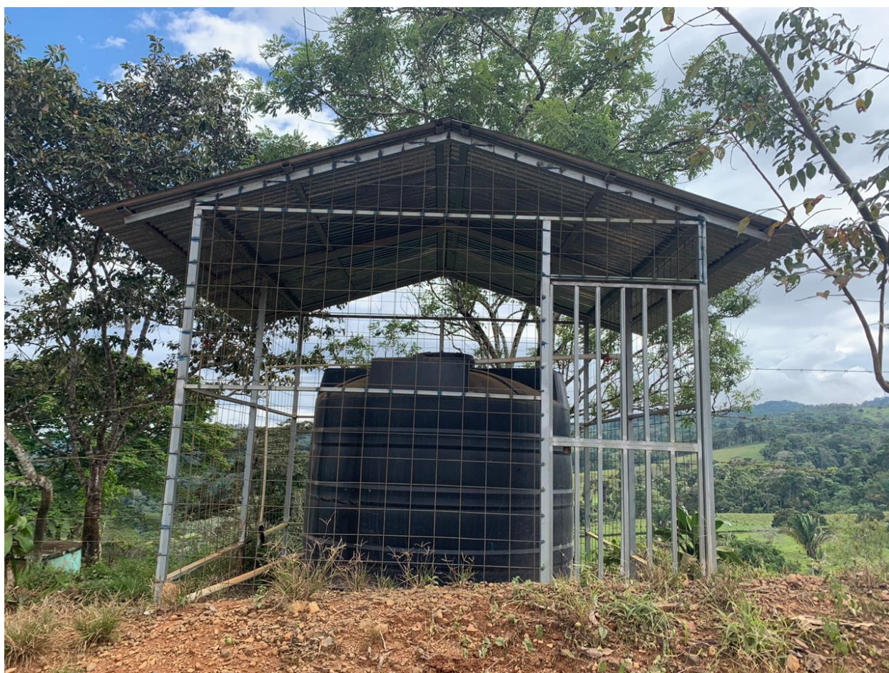
Tanque de Almacenamiento N°4
