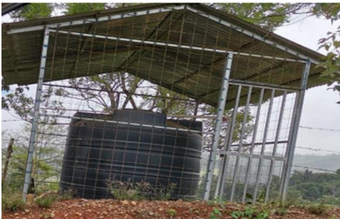
Tanque de Almacenamiento N°3.
