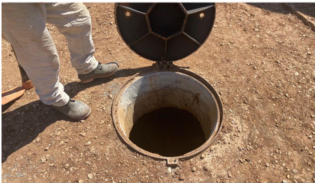
Anexo 28. Pozo de registro. (comunicación personal, diciembre 17, 2021)
