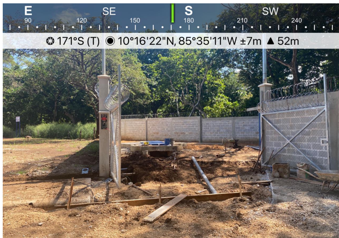
Anexo 27. Vista hacia la estación de bombeo. (comunicación personal, diciembre 17, 2021)
