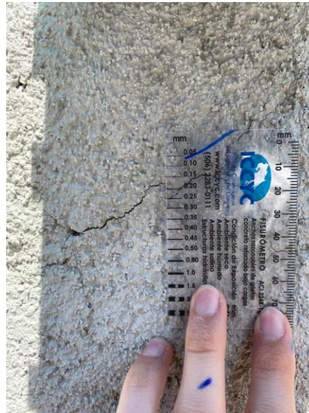
Figura 22: Uso del fisurómetro aplicado
