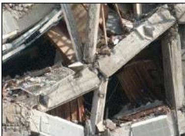
Figura 1. Terremoto y tsunami, 26 de diciembre de 2004 Sur Este de Asia Columna débil - viga fuerte, fracaso de las articulaciones viga-columna Centro Comercial "Panta Plrak" en Banda Aceh
