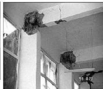
Figura 4. Terremoto, 17 de agosto de 1999, Kocaeli Turquía Falla de las conexiones viga-columna
