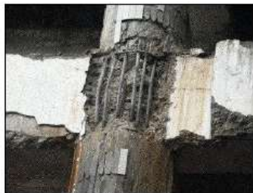
Figura 2. Terremoto y tsunami, 26 de diciembre de 2004 Sur Este de Asia Falla de la conexión viga-columna debido a la falta de refuerzo transversal Cuatro edificios de oficinas en Banda Aceh
