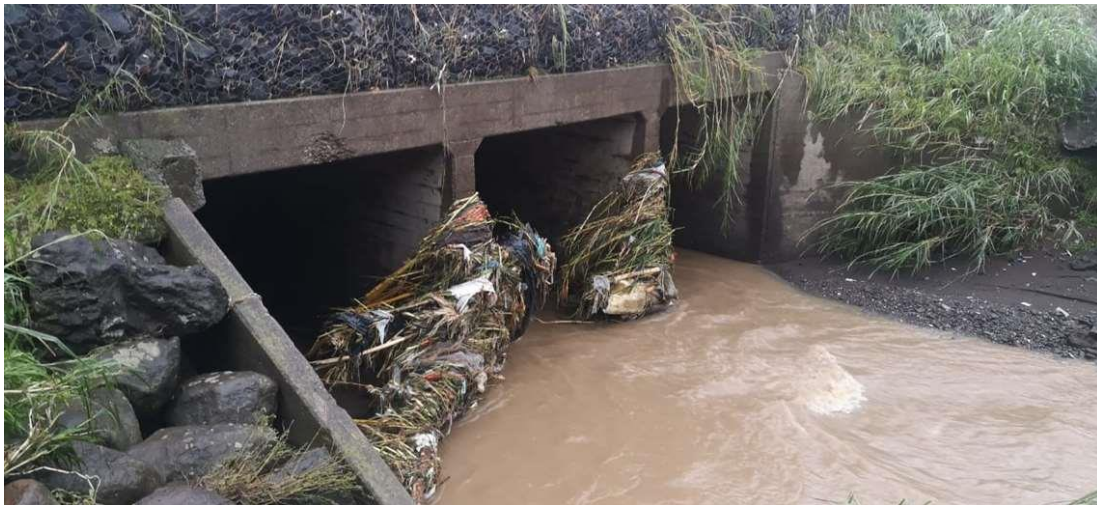
Figura 8.5. Causa de inundaciones en Autopista General Cañas. Fuente: (Peña, S, 2020).
