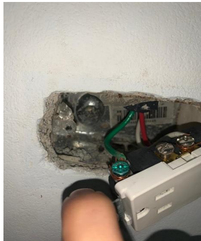
Figura 47. Mala instalación de receptáculos
