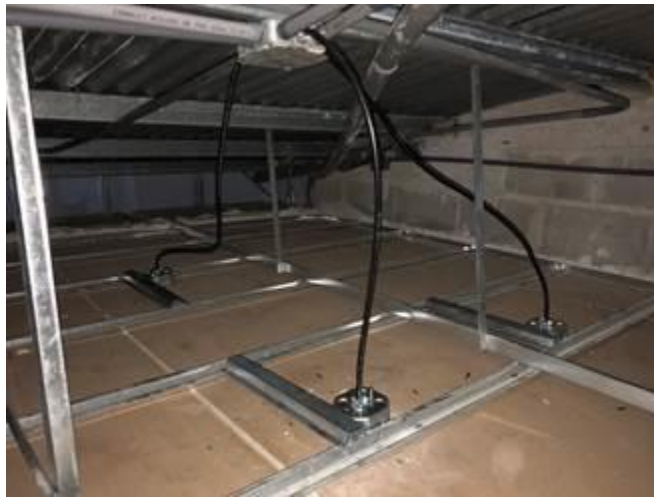
Figura 40. Correcta instalación de luminarias y sus colillas
