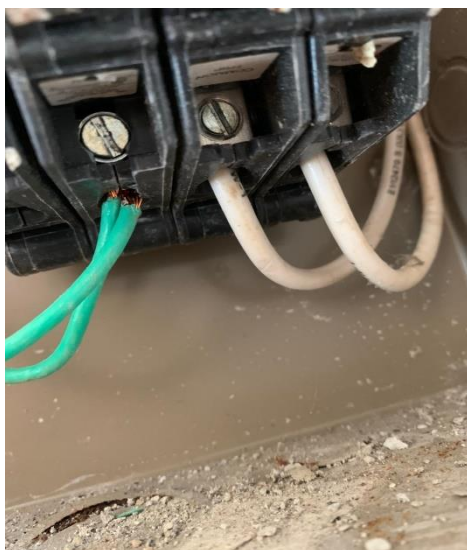
Figura 37. Incorrecta instalación de conductores
