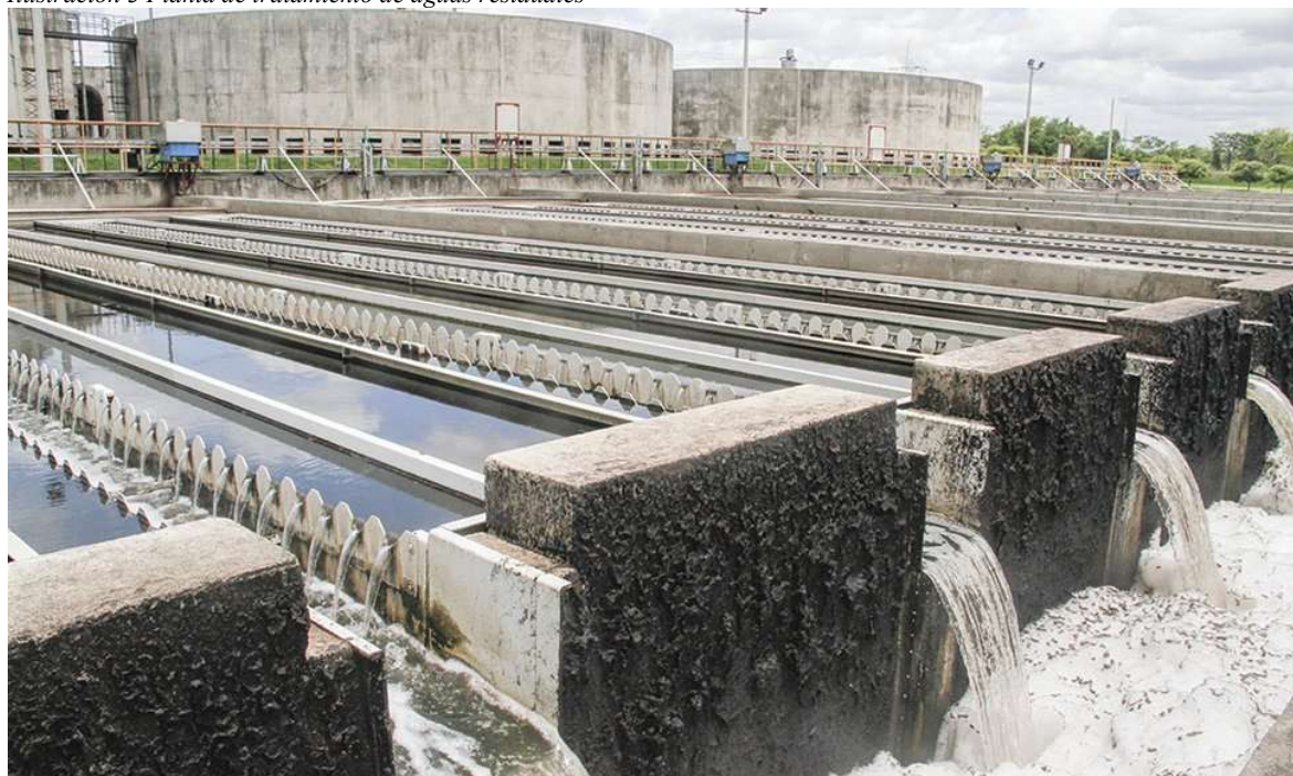
Ilustración 3 Planta de tratamiento de aguas residuales
