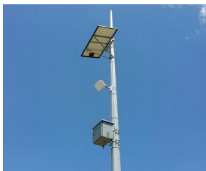
Figura 19. Estación permanente de radar
