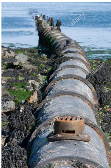
Ilustración 11. Tubería de conducción o emisaria
