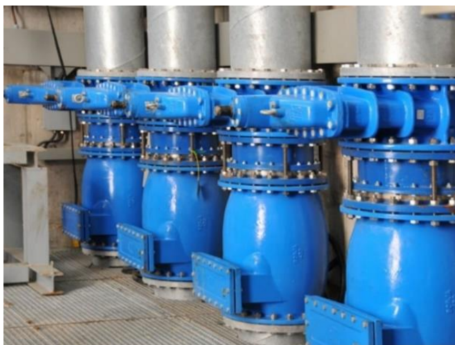
Ilustración 23. Estación de bombeo superficial
