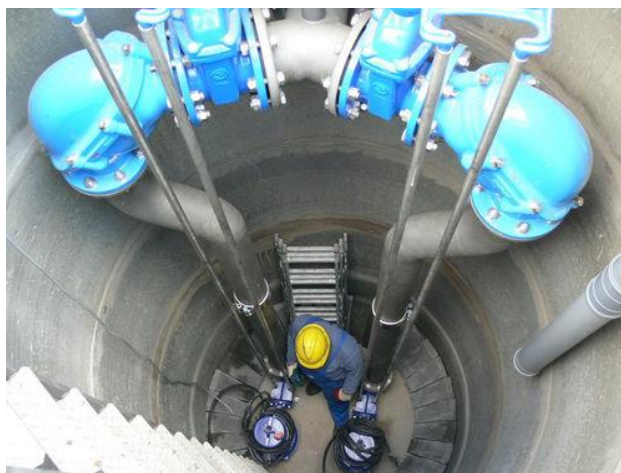
Ilustración 24: Estación de bombeo subterránea
