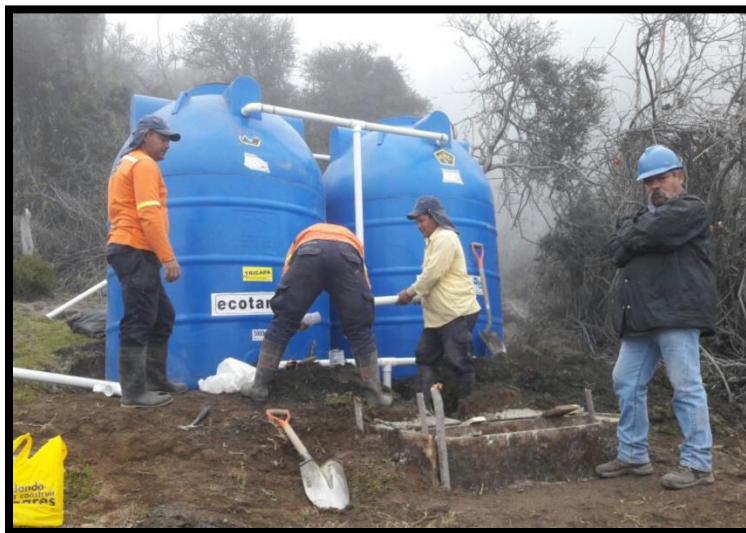
Imagen 1. Sistema de captación
