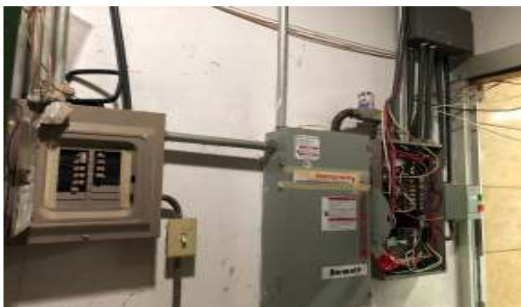
Figura 2.3: Transferencia manual, segundo y tercer centro de carga ubicados en la bodega de materias primas de la cocina. Fuente: Propia.
