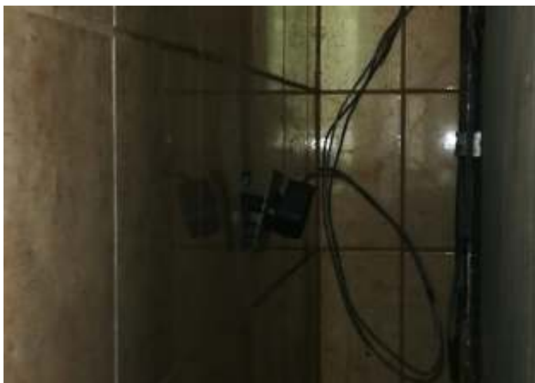
Figura 3.20: Tomacorriente cámara de refrigeración principal. Fuente: Propia.
