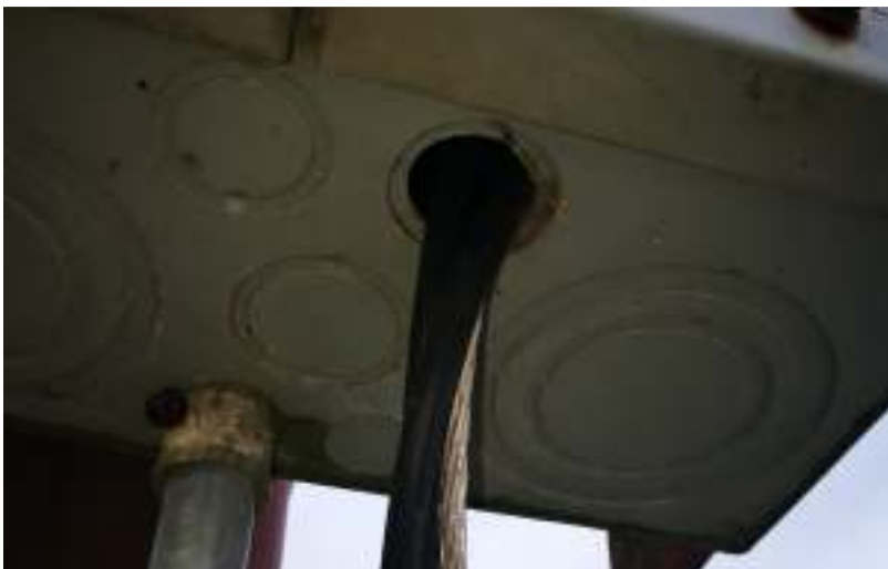
Figura 3.1: Salida de cableado hacia luminarias exteriores. Gabinete externo. Fuente: Propia.
