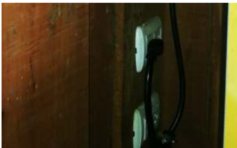
Figura 3.13: Conexión de cámaras de enfriamiento. Bar. Fuente: Propia.
