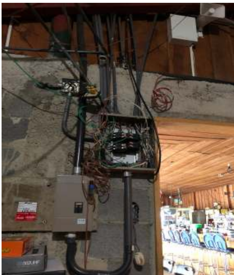
Figura 2.2: Primer centro de carga ubicado en la bodega principal de materiales.
