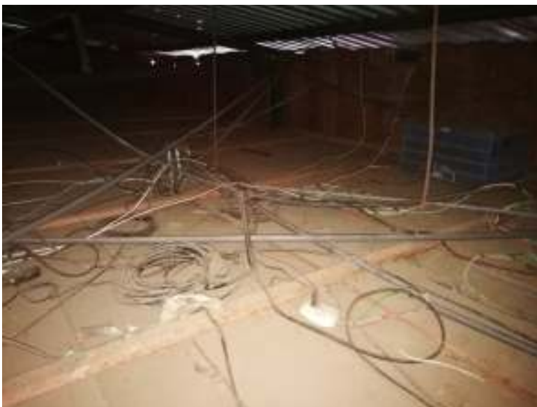
Figura 3.6: Cableado sin canalización en cielo falso. Fuente: Propia.
