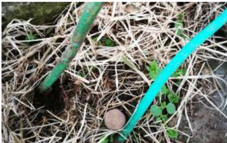
Figura 3.2: Conexión de cable de tierra a la varilla de tierra. Fuente: Propia.
