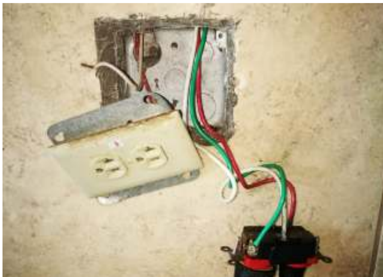
Figura 3.19: Tomacorrientes cocina. Fuente: Propia.
