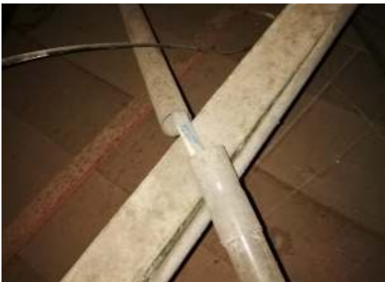
Figura 3.7: Alimentación de centro de carga en contacto directo con la estructura metálica. Fuente: Propia.
