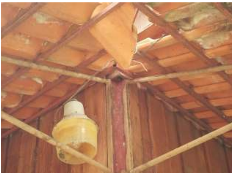
Figura 3.15: Luminaria exterior con deficiencias de instalación. Fuente: Propia.
