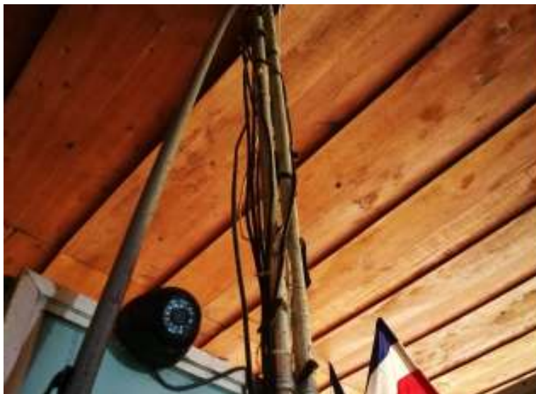
Figura 3.11: Bajante para cables. Caja. Fuente: Propia.
