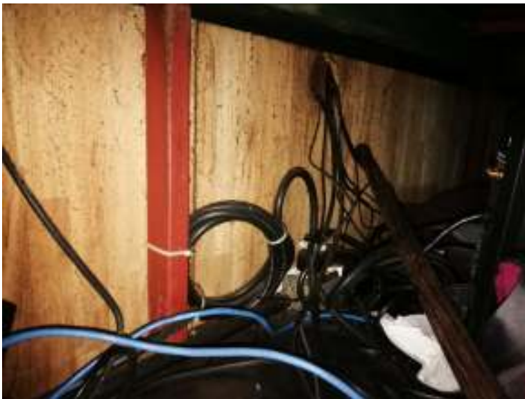
Figura 3.10: Conexión de equipo de cómputo bajo el mueble de control de calidad de platillos. Fuente: Propia.
