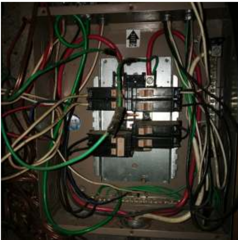
Figura 3.9: Centro de carga secundario, bodega principal. Fuente: Propia.
